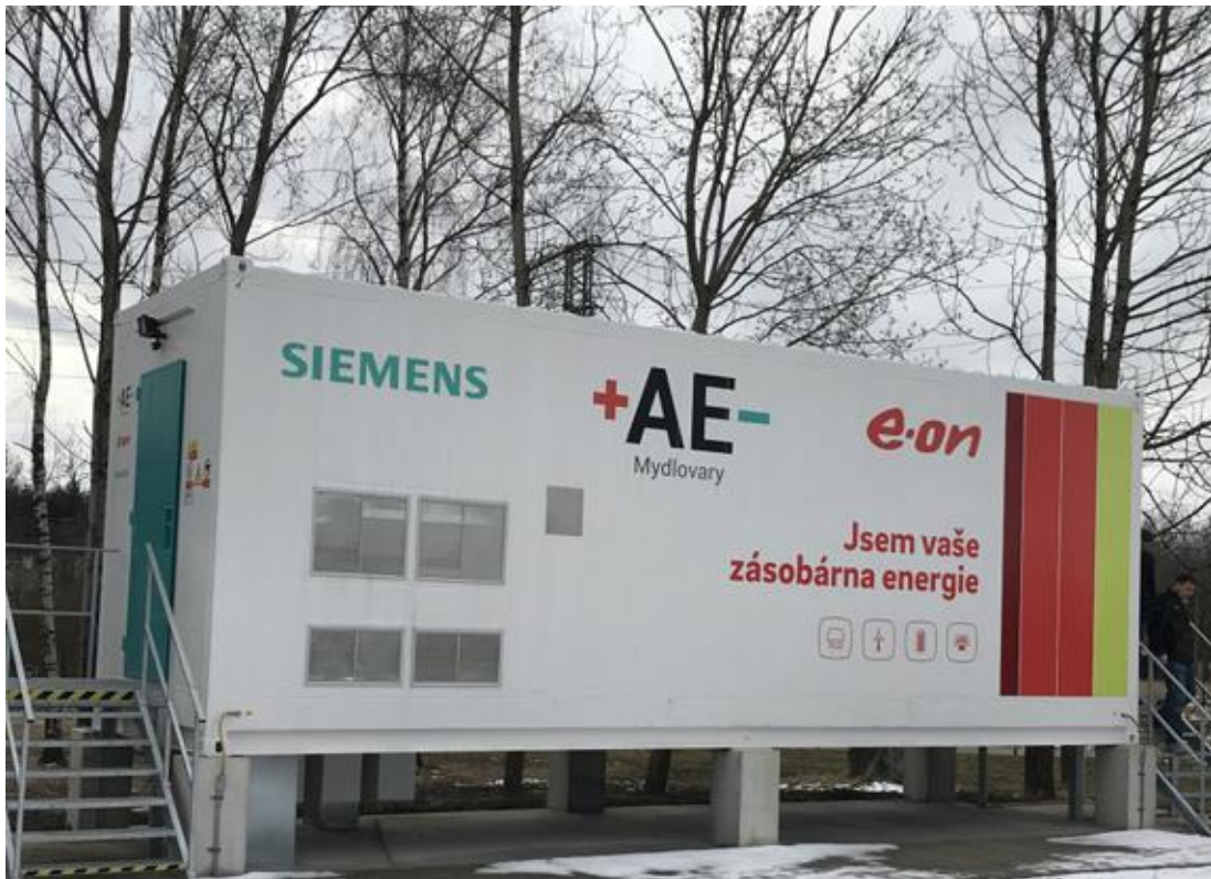
Obrázek 12: Lithium-iontový bateriový systém 1,75 MWh, Mydlovary, Česká Republika
