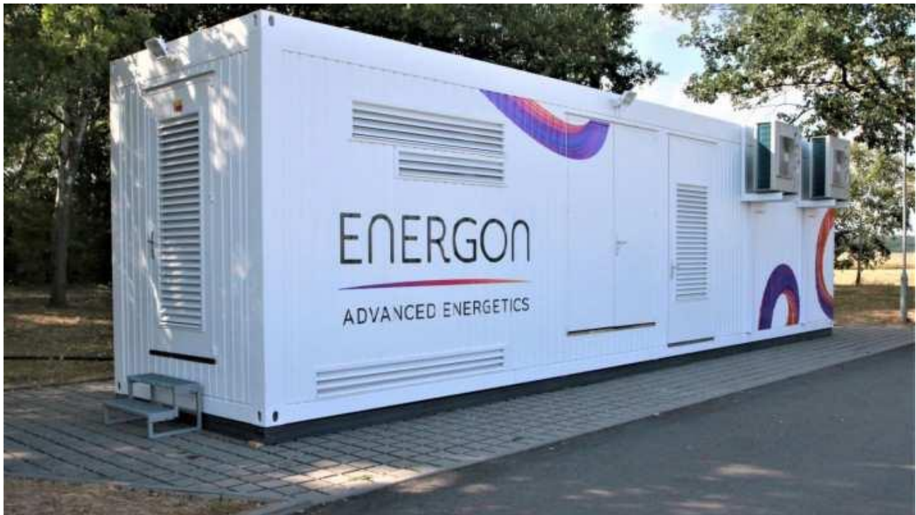
Obrázek 14: Lithium-iontový bateriový systém 1,3 MWh, Obořiště, Česká Republika
