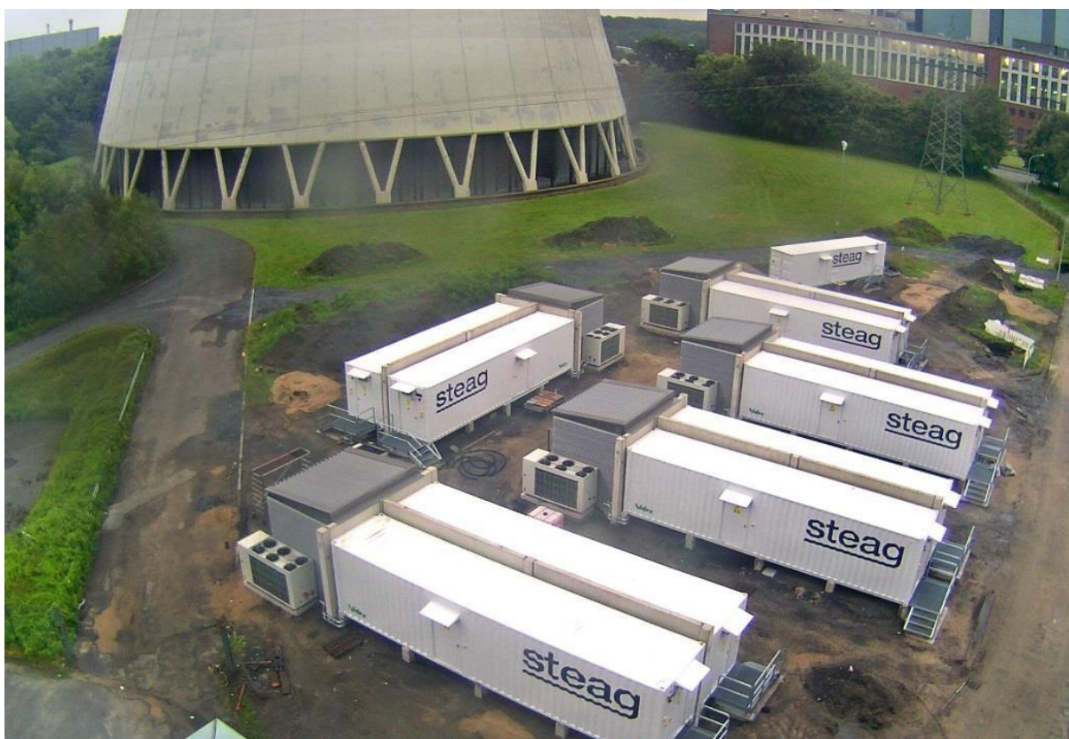
Obrázek 8: Instalace 15 MW lithium-iontových bateriových systémů na elektrárně ve městě Lünen
