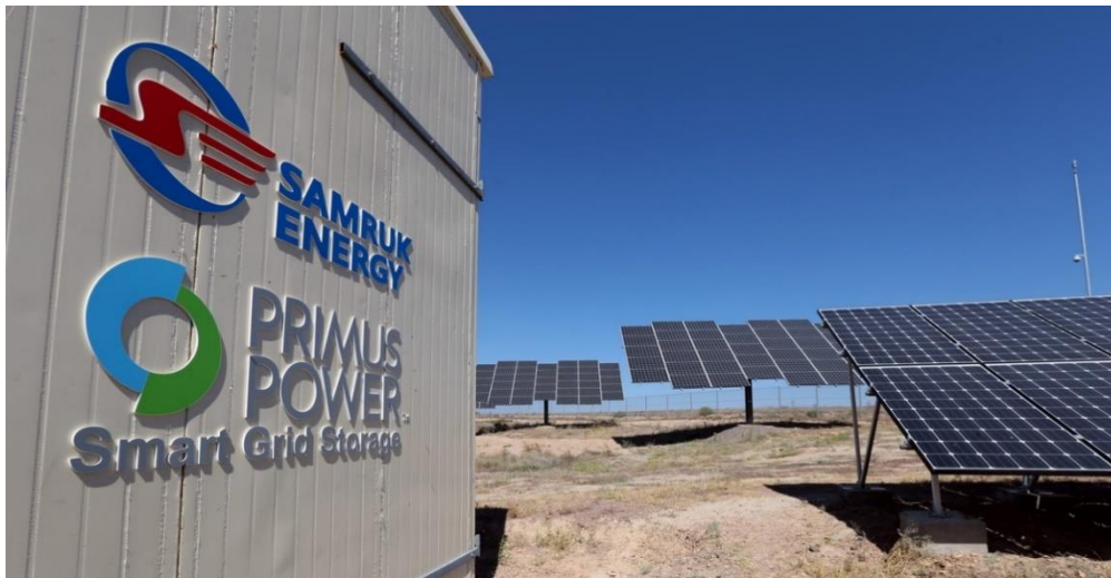
Obrázek 15: Instalace 250 kW zinek-bromidového bateriového systému v Kapšagaji, Kazachstán
