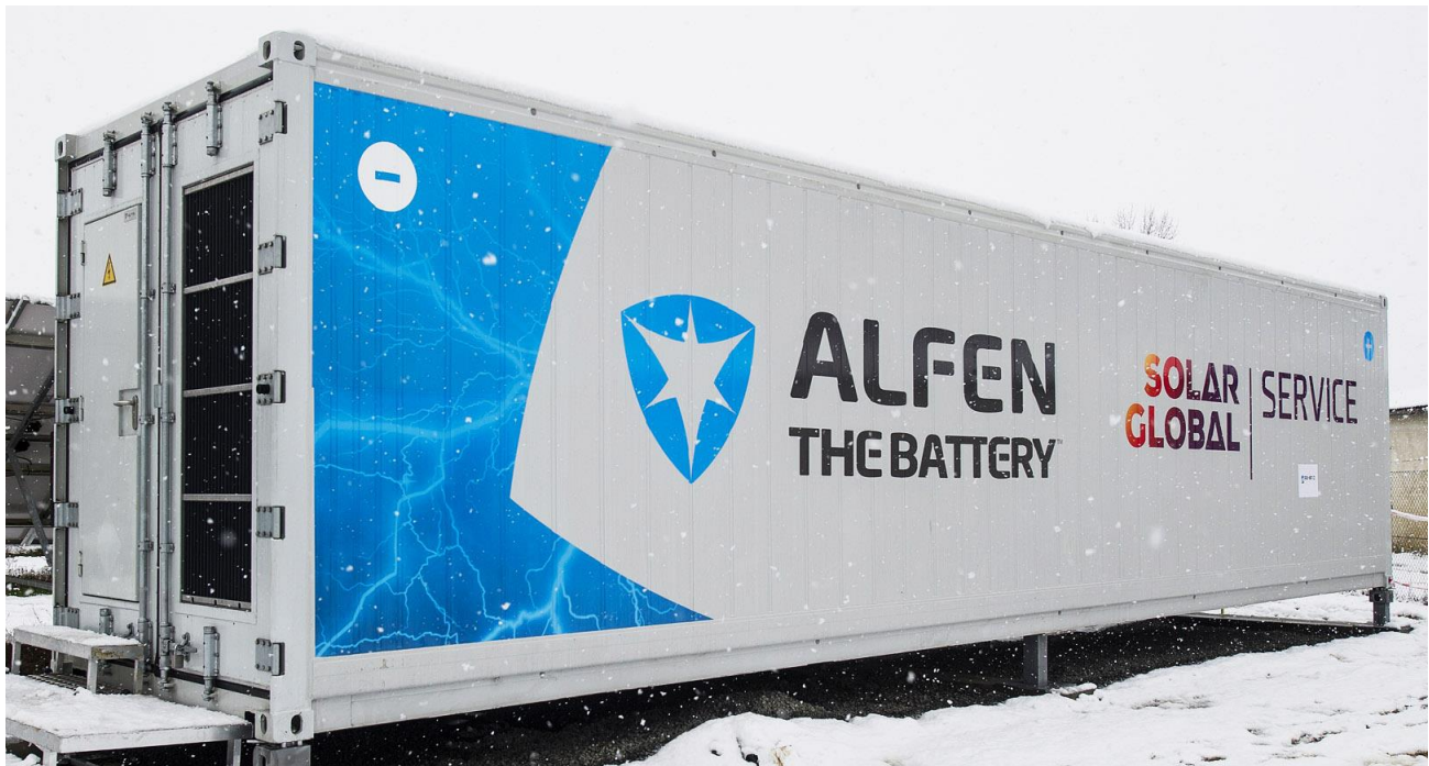
Obrázek 13: Lithium-iontový bateriový systém 1,2 MWh, Prakšice, Česká Republika
