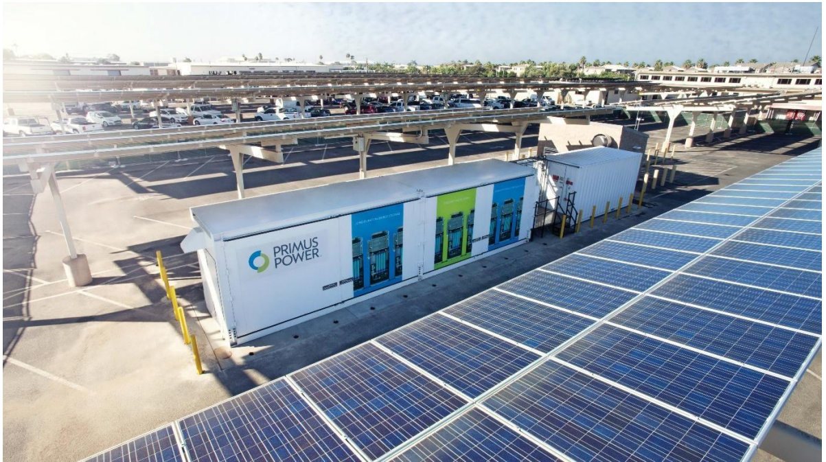
Obrázek 11: Instalace 250 kW zinek-bromidového bateriového systému v San Diegu v USA
