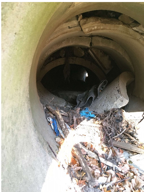
Obrázek 20: Zřícení betonové trouby DN1000
