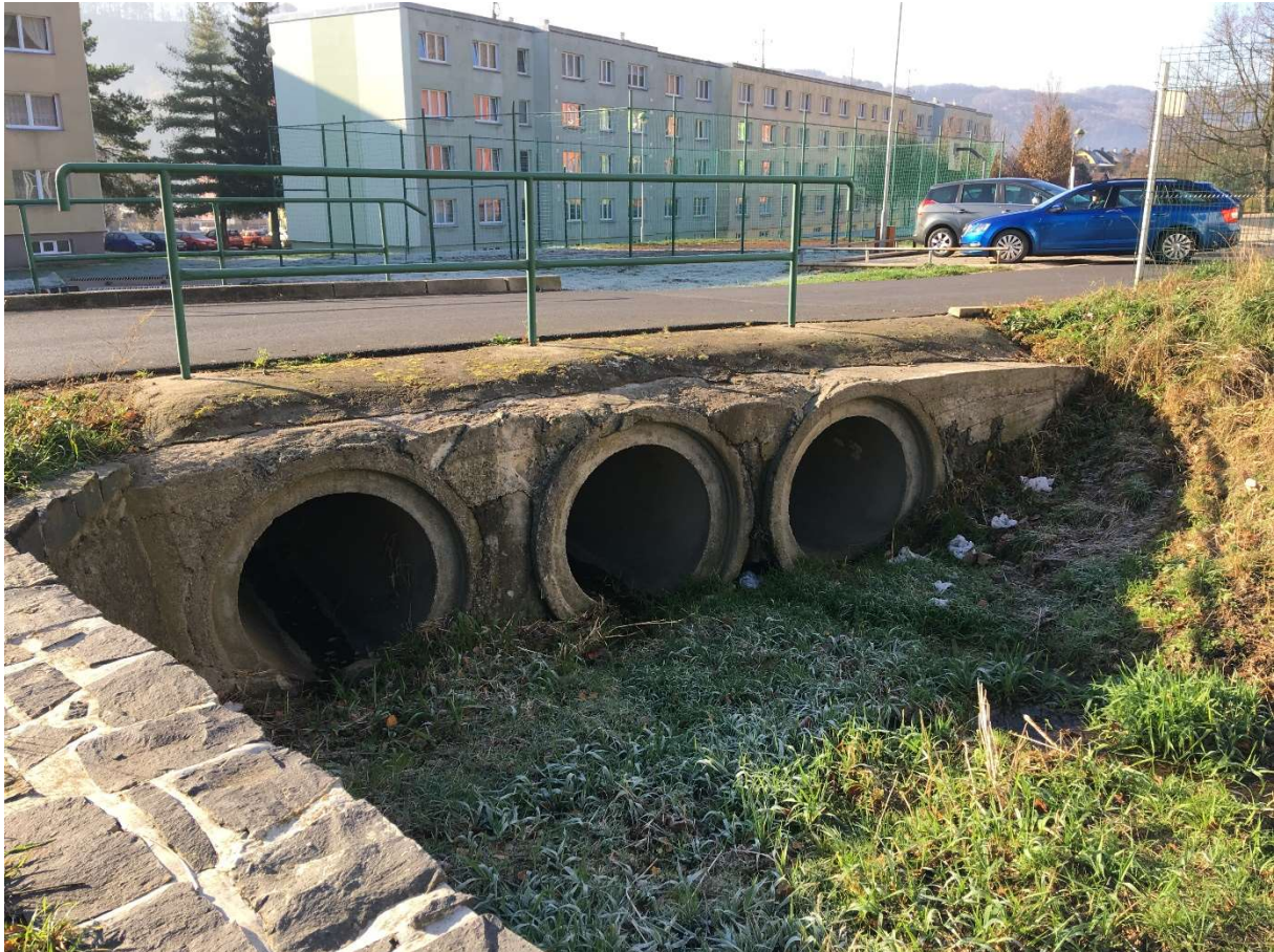
Obrázek 8: Propustek 3x DN1200
