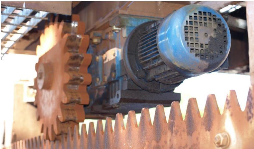
Obrázek 10 příklad pohonu usazovací nádrže ČOV Litovel [20]
