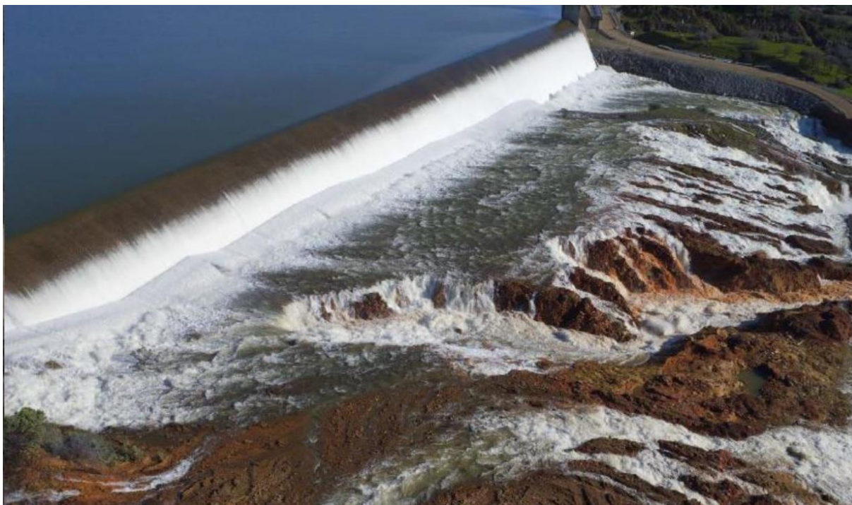
Obr. 4. Postup eroze pod nouzovým přelivem 12. 2. 2017 [8].
