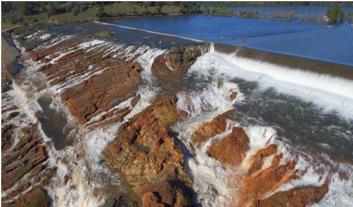
Obr. 3. Postup eroze pod nouzovým přelivem 12. 2. 2017 [7].
