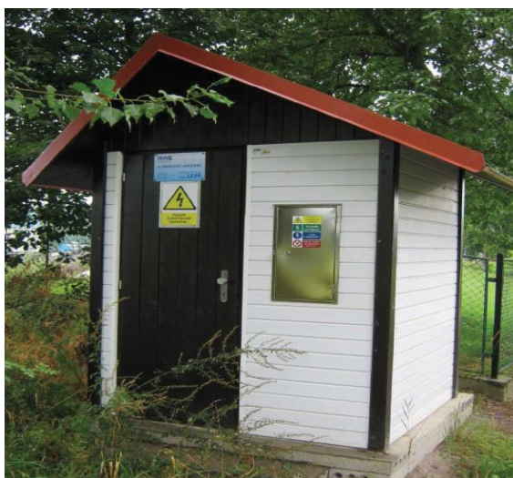
Obr. 13 Stanice katodické ochrany [42]
