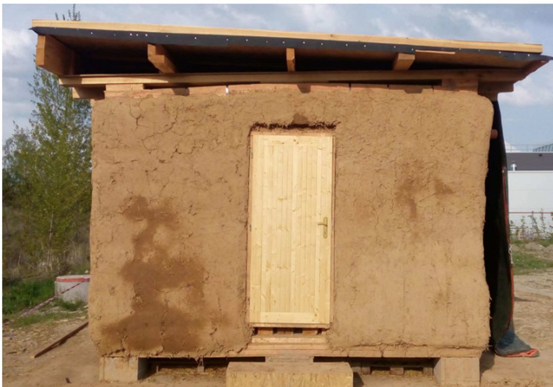
Obr. č. 21 Nerovnost stěny po nanesení hrubé vrstvy omítky
