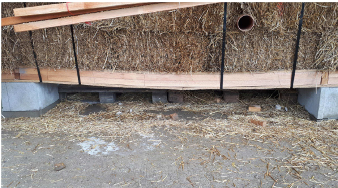
Obr. č. 18 Viditelný průhyb spodního nosného věnce
