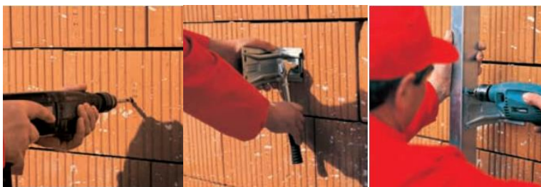
Obr. 14: Vrtání otvorů pro uchycení konzol, kotvení konzol k obvodové stěně, montáž nosných profilů [20]
