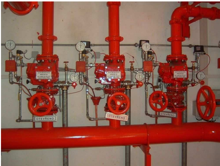
- Obr. 15 - Strojovna pěnového hasicího zařízení [10]
