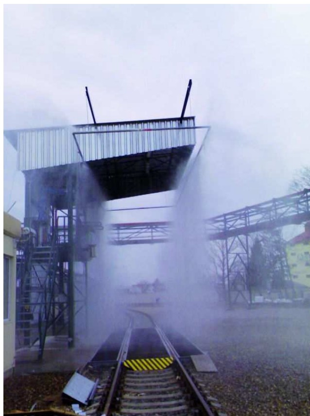
Obr. 10 – Zkouška drenčarového hasicího zařízení [5]
