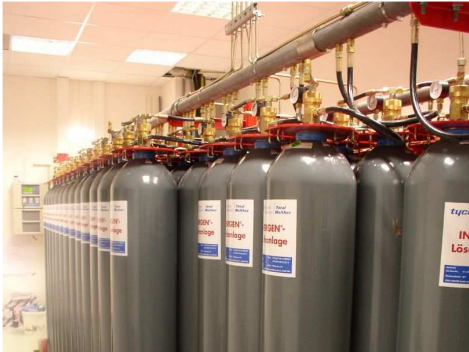
- Obr. 19 - Zásobníky Inergenu IG -541 [13]
