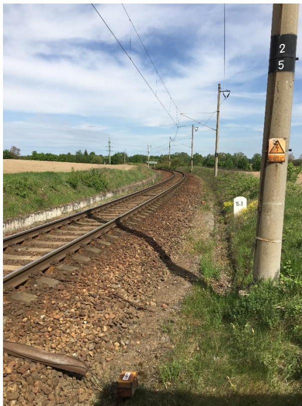
Foto č. 6 – Směrový oblouk proti směru staničení v km 15,300
