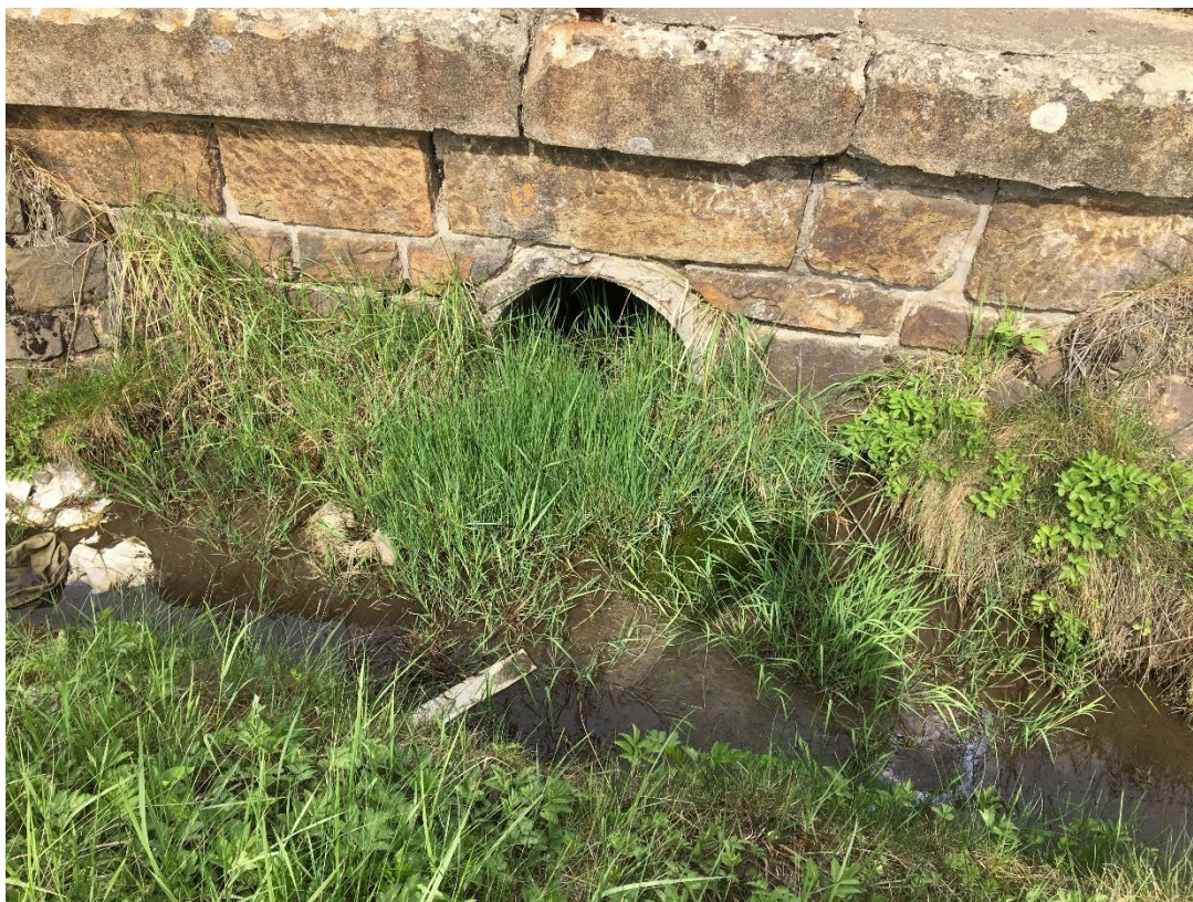
Foto č. 31 – Neudržovaný propustek v km 26,262
