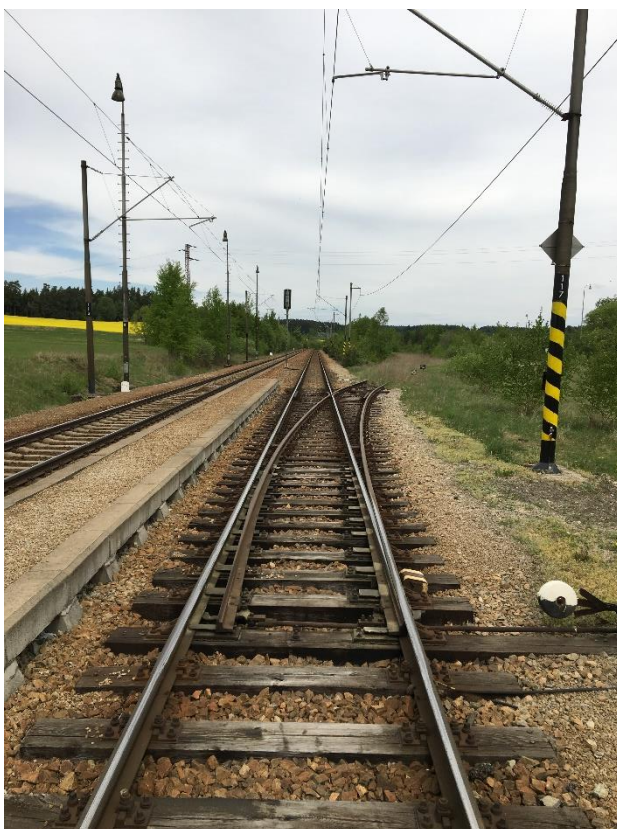
Foto č. 14 – Výhybka č. 3 v km 19,576 ve směru staničení
