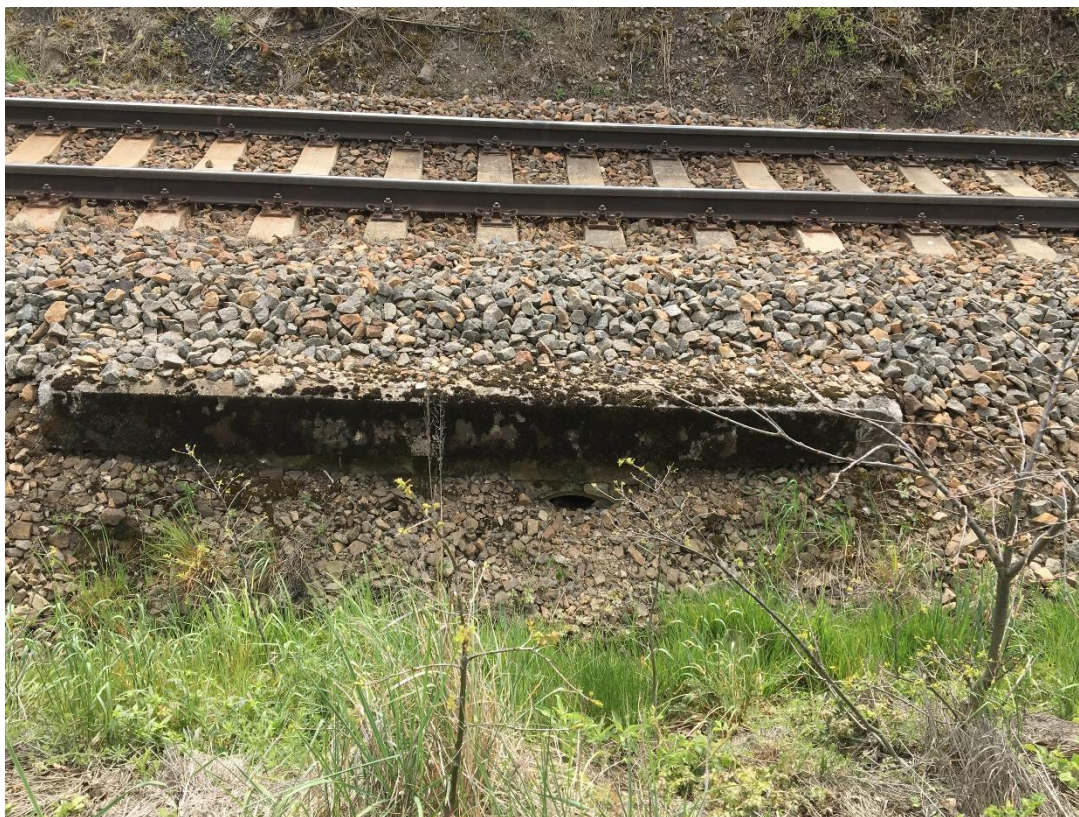
Foto č. 30 – Zasypaný propustek v km 24,922
