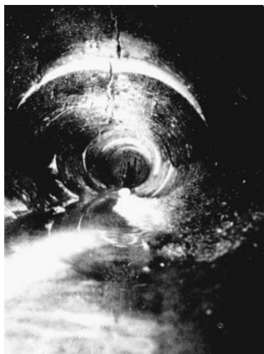
Obrázek 14: Příklad posouzení poškození, Kategorie poškození 5 – trhliny [23]
