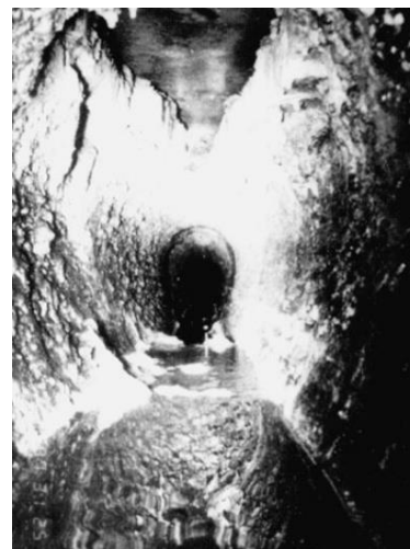
Obrázek 15: Příklad posouzení poškození, Kategorie poškození 3 – infiltrace [23]
