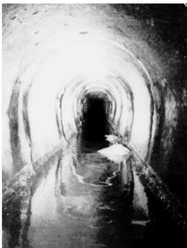
Obrázek 13: Příklad posouzení poškození, Kategorie poškození 5 – koroze [23]
