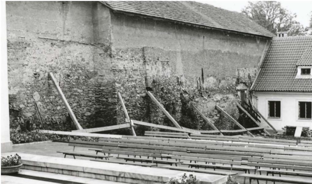
Obrázek 9: Stabilizace jižní nosné zdi objektu konírny pomocí dřevěných trámů; pořízeno okolo roku 1980
