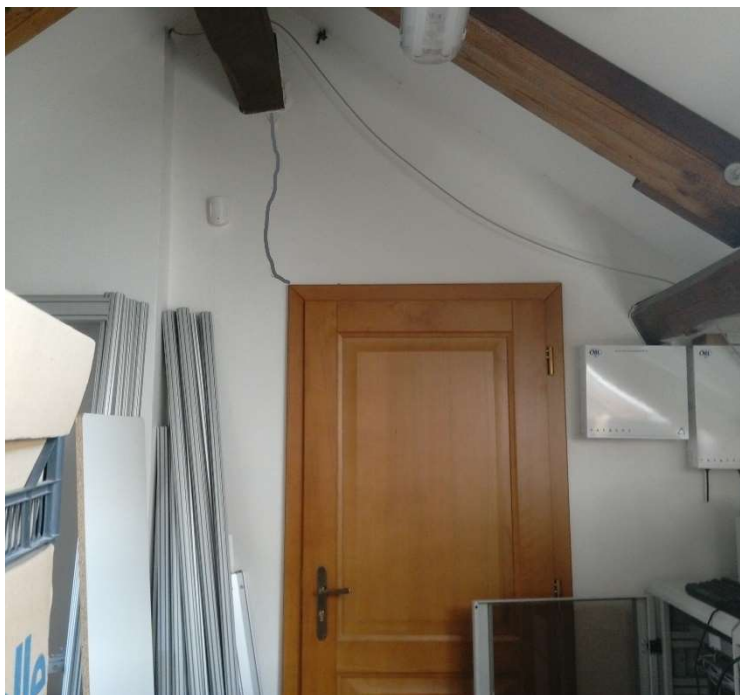
Obrázek 22: Trhlina pod vrcholovou vaznicí
