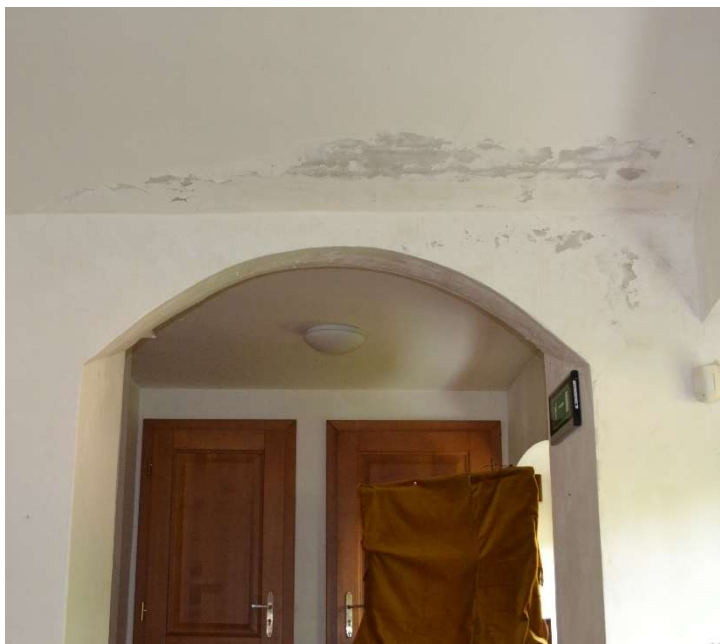
Obrázek 20: Opadající nátěr u okenního nadpraží v západní části budovy
