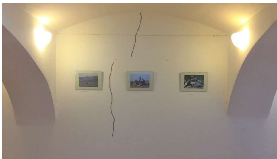
Obrázek 21: Trhliny ve východní části objektu
