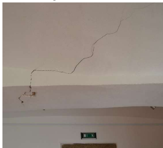
Obrázek 27: Detail trhliny na klenebním pasu
