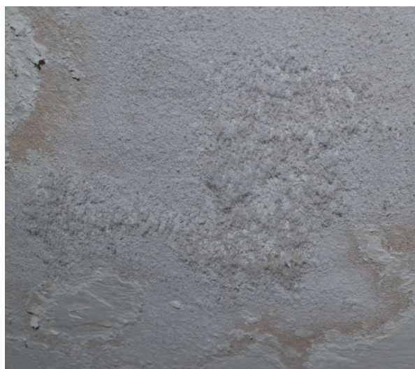
Obrázek 65: Výkvěty solí na povrchové úpravě
