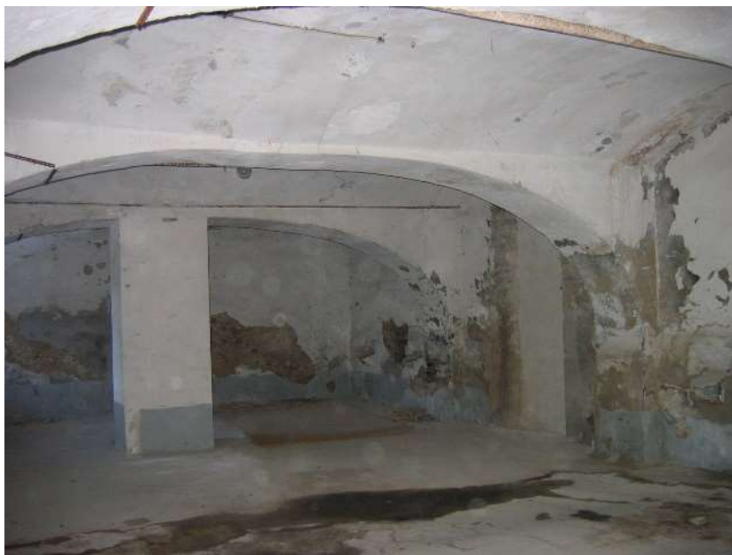
Obrázek 7: Podepření klenebního pásu zděným pilířem
