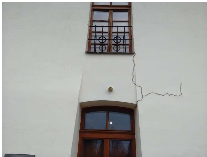
Obrázek 23: Trhliny na jižní fasádě
