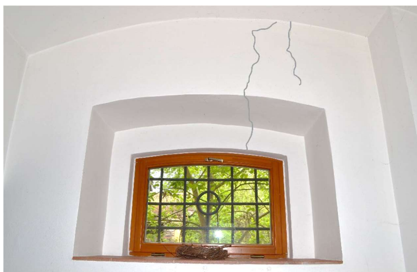
Obrázek 28: Trhlina v nadpraží
