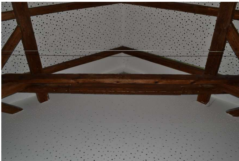
Obrázek 48: Podhledové akustické desky na podhledu krovu a přilehlé příčce
