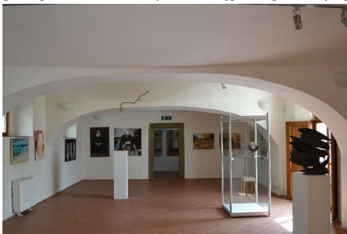
Obrázek 26: porušení klenebního pasu
