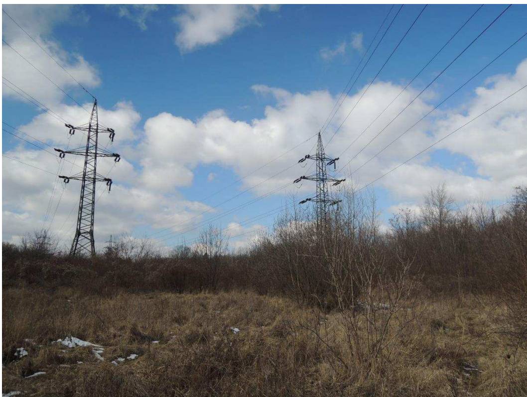
Fotografie 16 pohled na vedení VN směr Ďáblice, TT ve variantě Jih vedena po pravé straně v souběhu s vedením VN
