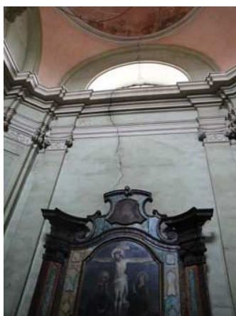
Obr. 62: Trhlina v hlavní lodi v severní stěně
