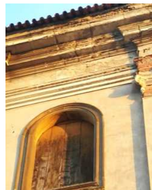
Obr. 61: Porušená římsa v místě okna nad kaplí
