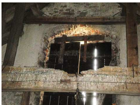
Obr. 56: Porušený zdvojený hambálek v první vazbě
