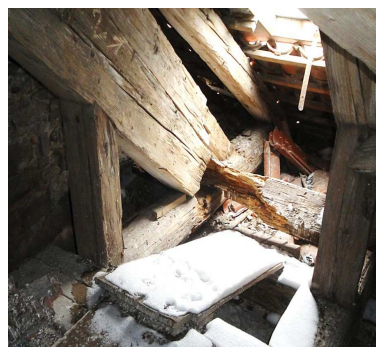
Obr. 57: Chybějící výplň střešního okna a porušené prvky v tomto místě
