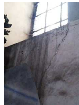
Obr. 59: Zatékající voda oknem presbytáře
