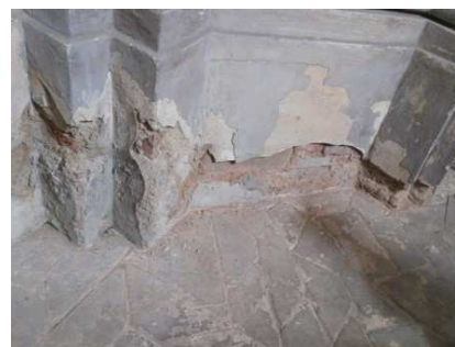
Obr. 52: Poškozená omítka v hlavní lodi
