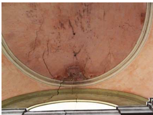
Obr. 64: Poškození kopule hlavní lodi 1
