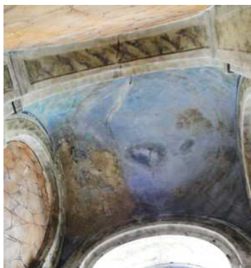
Obr. 60: Porušení stropu kaple
