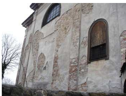
Obr. 54: Poškozená omítka na severní straně
