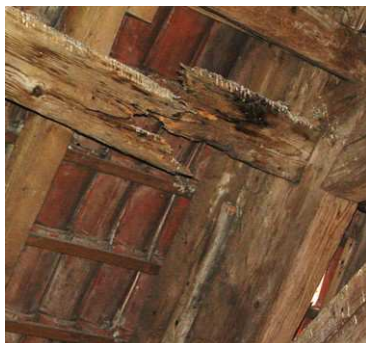
Obr. 58: Přerušená vaznice mezi první a druhou vazbou
