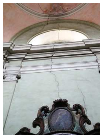
Obr. 63: Trhlina v hlavní lodi v jižní stěně
