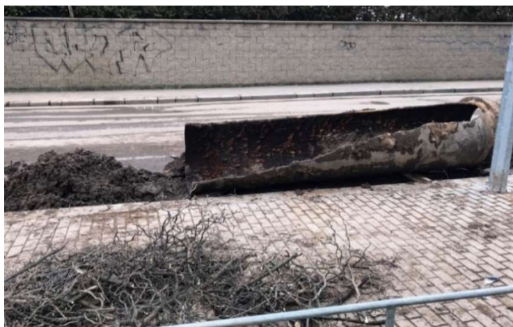
Obr. 89 - Prasklé vodovodní potrubí [4]
