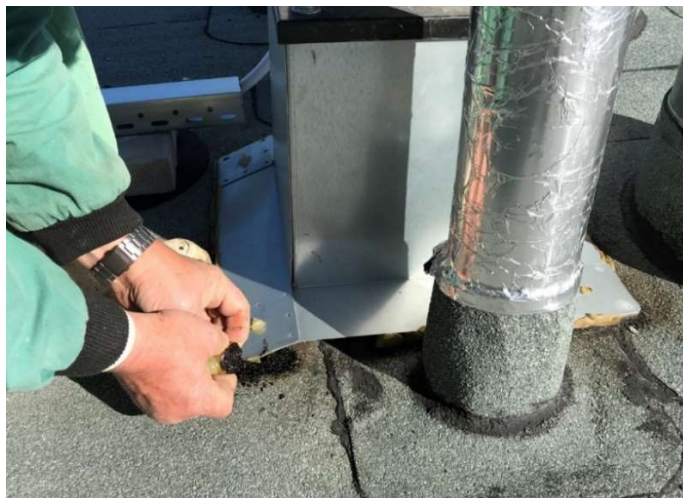
Obr. 66 - Detail poškození hydroizolace [4]
