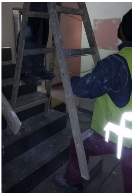
Obr. 88 - Nebezpečná podpěra žebříku [4]
