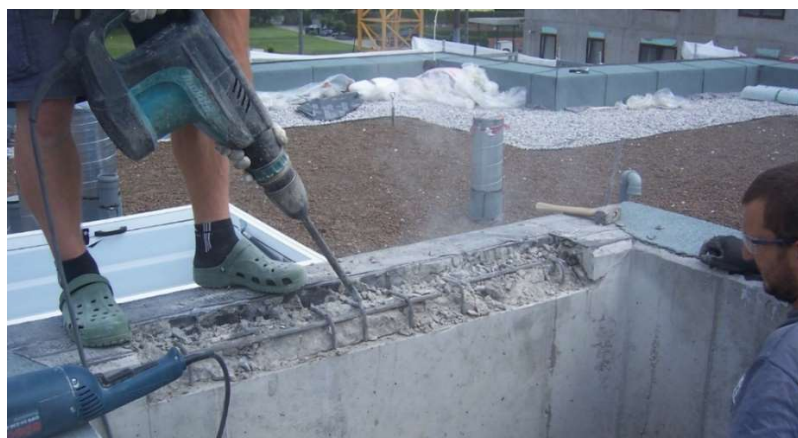
Obr. 85 - Nebezpečí při bouracích pracích [4]
