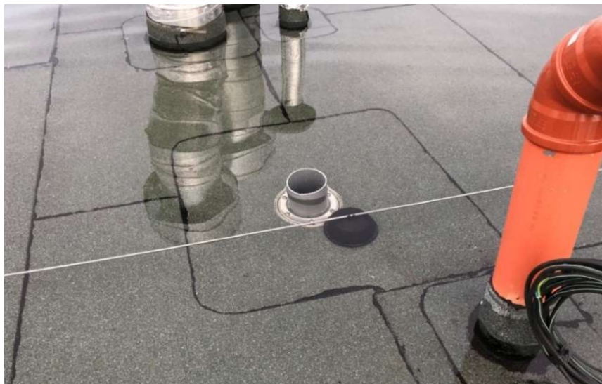
Obr. 68 - Pohled na zatopení kolem střešní vpusti [4]
