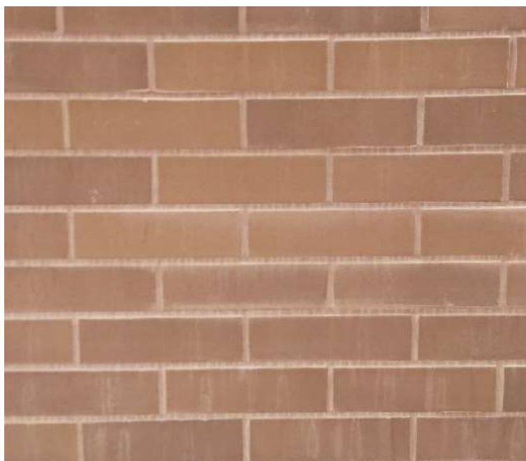
Obr. 36 - Výkvěty na fasádě [4]
