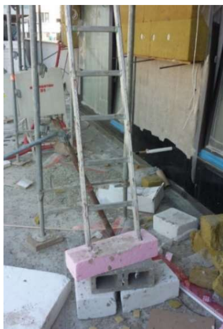
Obr. 84 - Chybné podložení žebříku [4]
