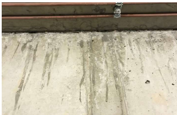
Obr. 82 - Přetoky betonu u napojení stěny a stropu [4]
