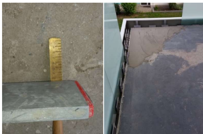
Obr. 59 - Nerovnosti desek balkonů [4]
