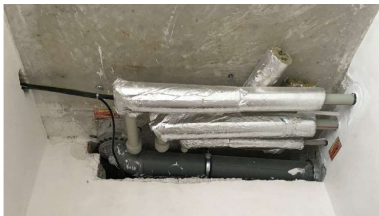
Obr. 78 - Kolize potrubí a příčky [4]
