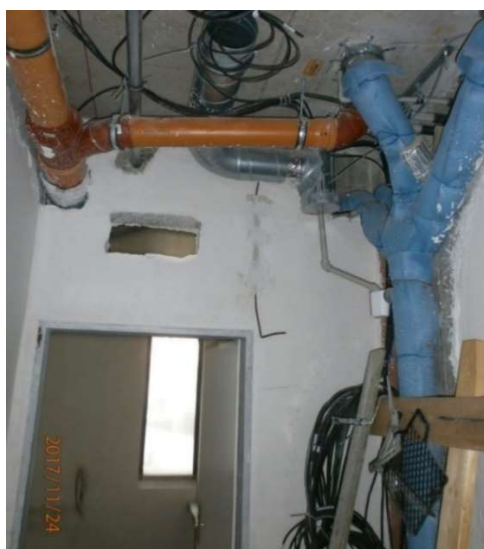
Obr. 77 - Složitě řešené rozvody vody a VZT [4]
