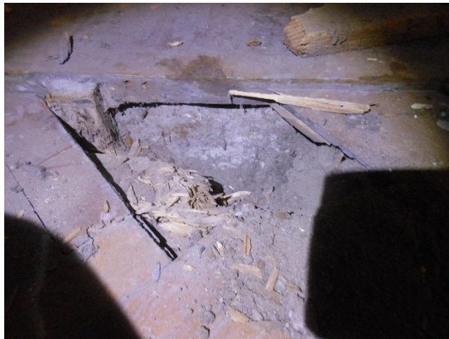
Stav dř. podlahy destruované hnilobou 1
