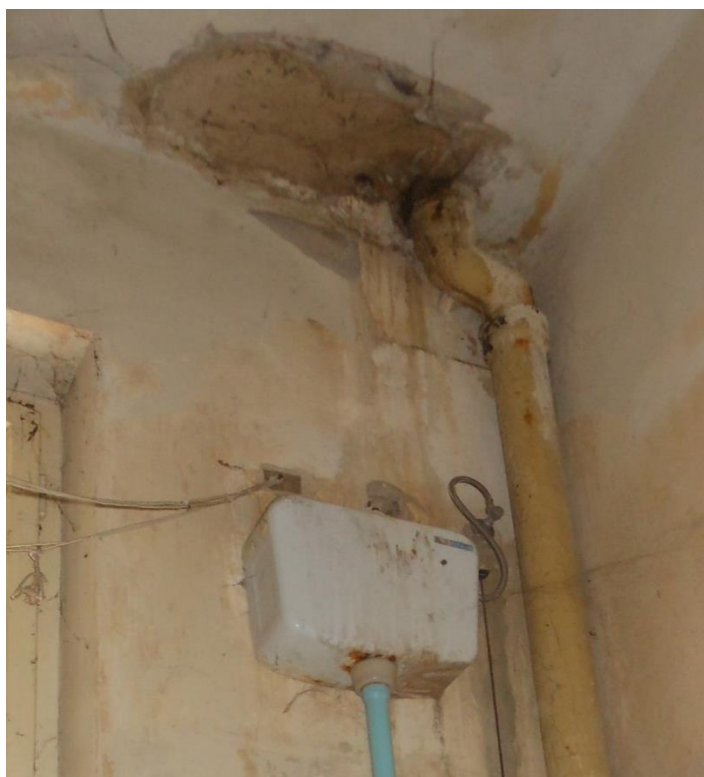
Stav stropu a omítky v interiéru 2
