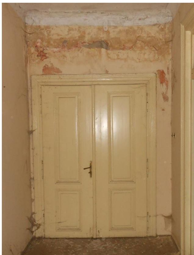
Povrchová kondenzace nad vstupním dveří 1
