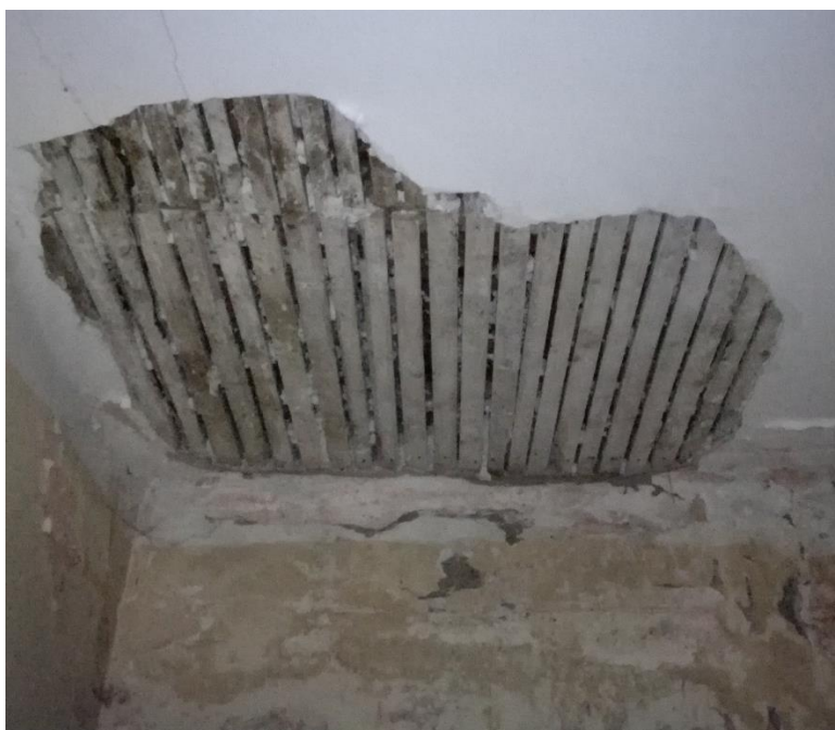
Strop destruovaný hnilobou 2
