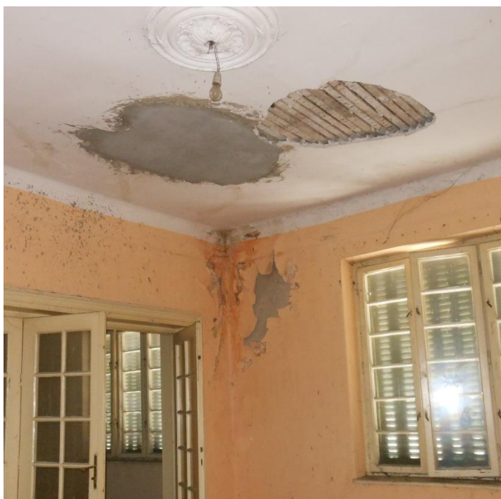
Stav stropu a omítky v interiéru 1
