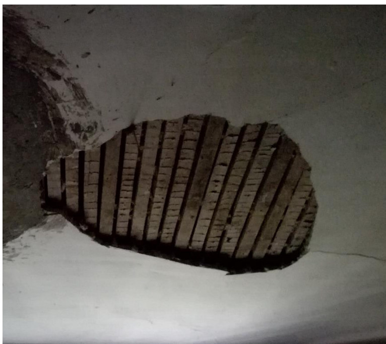
Strop destruovaný hnilobou 1
