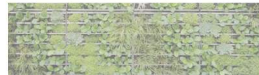
POPÍNAVÉ ROSTLINY NA FASÁDĚ
