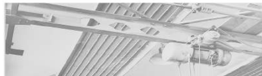
ZAVĚŠENÉ TOPNÉ SÁLAVÉ PANELE
