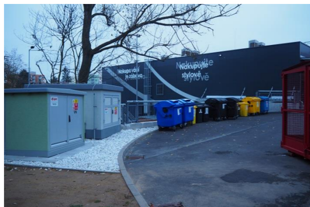
Obr. 53) Trafostanice a sběrné místo za nákupním centrem [25]
