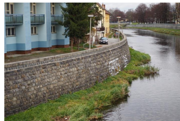
Obr. 40) Nevyhovující cesta při levém břehu Otavy [25]
