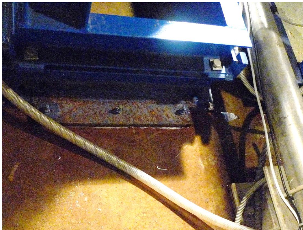
Obr 5.7 Povrchová koroze, prosáklá voda
