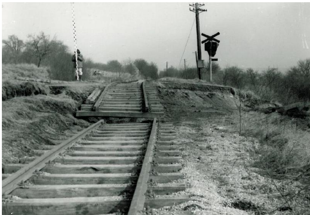
Obr. 2: Přerušování drážního tělesa v úrovni křížení se silnicí (zdroj: Rybář, 1982)
