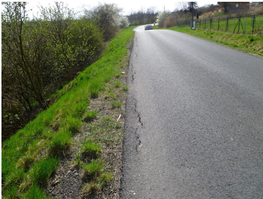
Obr. 5: Trhlina na vozovce (2018)
