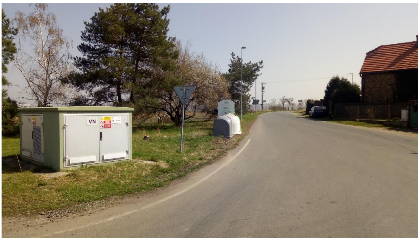
Obrázek 27: Transformační stanice s přechodem nadzemního vedení VN do podzemního, vlastní fotografie (duben 2018)
