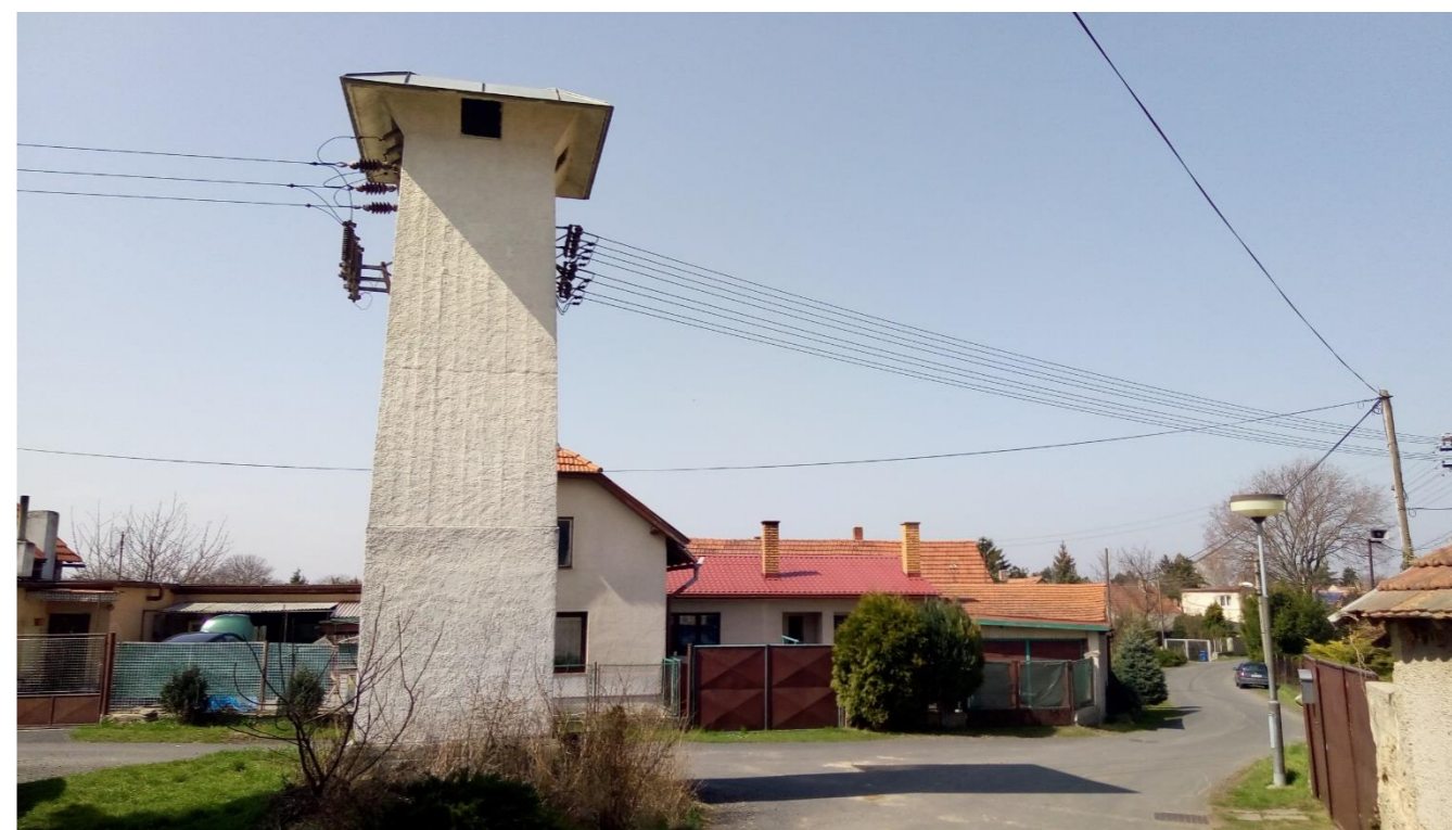
Obrázek 42: Zděná transformační stanice, vlastní fotografie (duben 2018)
