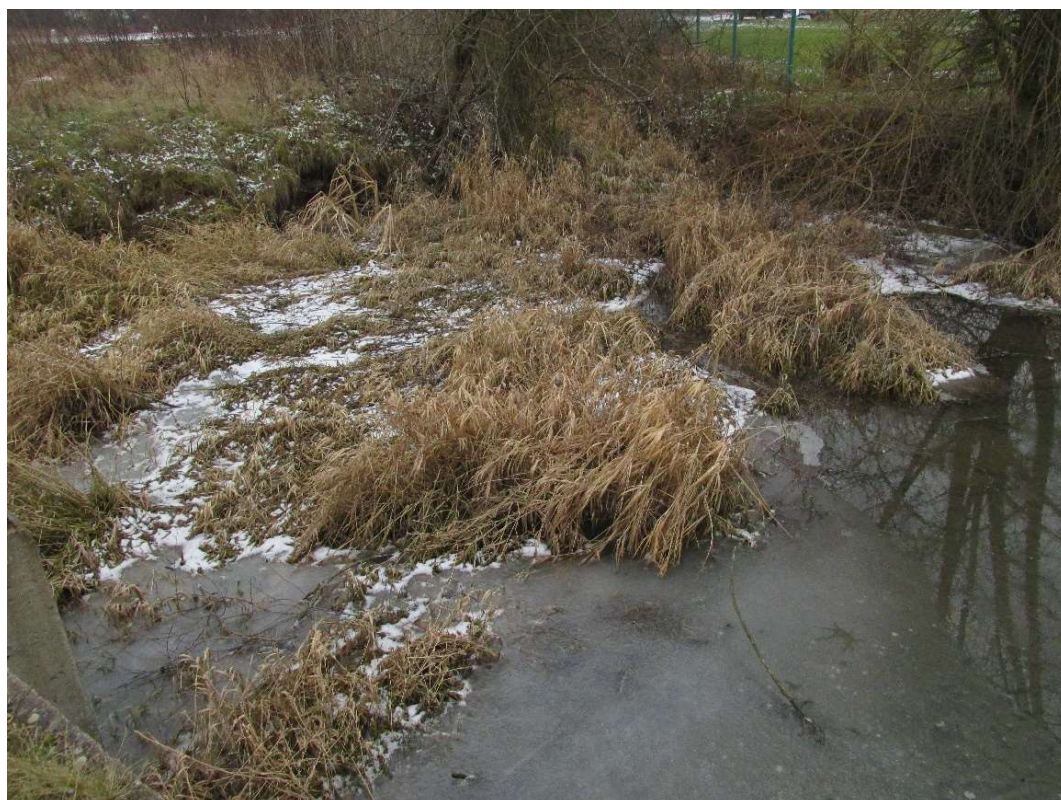
Obr. č. 7 – Horní část nádrže, zarůstání vegetací
