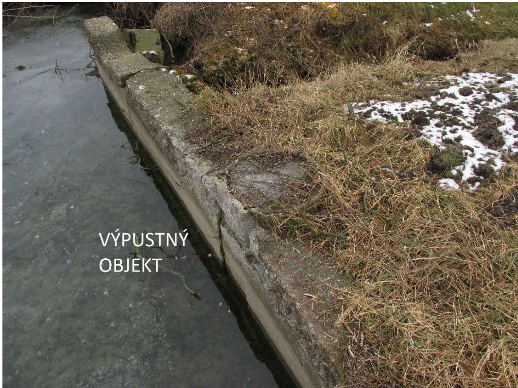
Obr. č. 4 – Výpustný objekt se zaneseným nátokem
