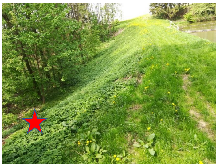
Obr. 39 - Lokalizace průsaku v hrázi, zdroj: vlastní archiv
