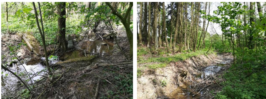
Obr. 27 - Zerodované koryto pod hrází, zdroj: vlastní archiv
