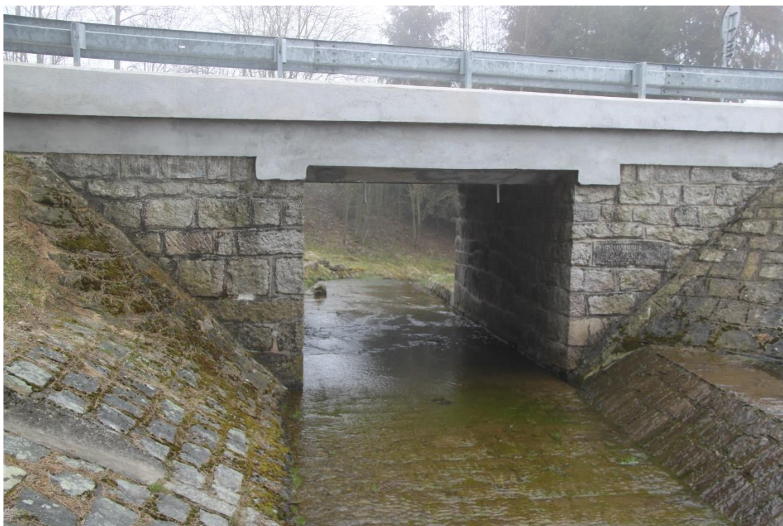
Obrázek 4 - Nekapacitní mostní propustek
