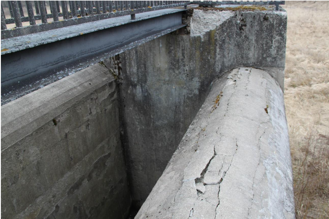
Obrázek 14 - Povrchové poškození ŽB bloků sruženého objektu
