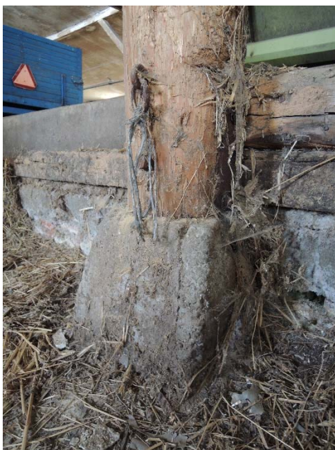
obr.12 – Uložení dřevěného kruhového sloupu na betonovou patku v místě stájí (vlevo)
