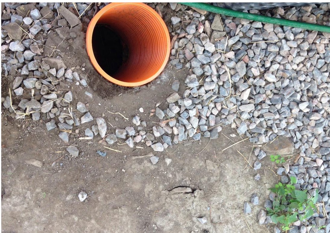
Obr. 18 Revizní šachta drenážního systému (autor Jan Illetško)
