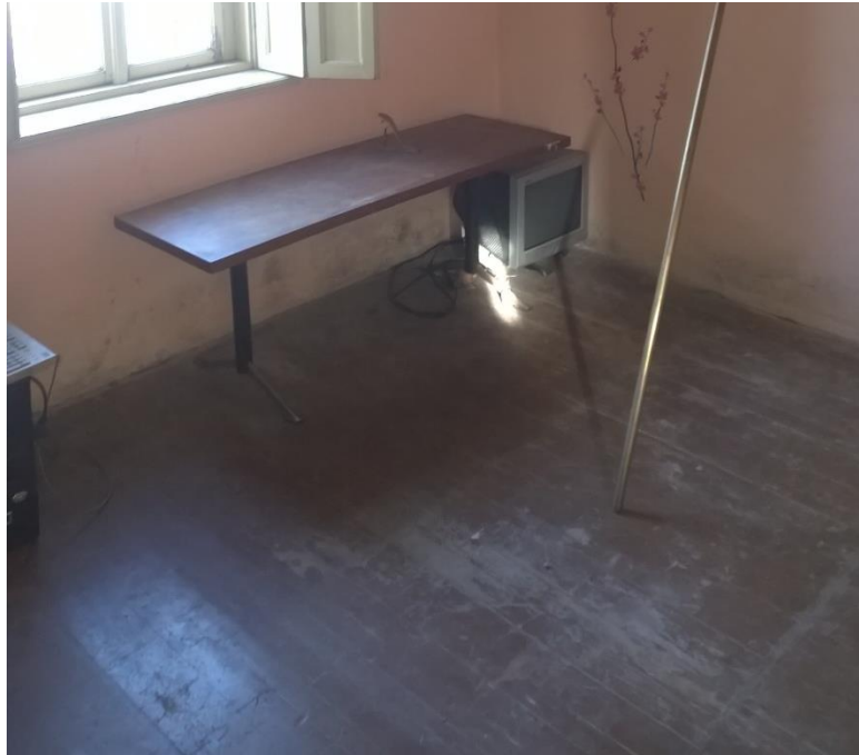
Obr. 2 plíseň a sanytr u spodního okraje zdiva (převzato od Ing. Jan Klatovec)
