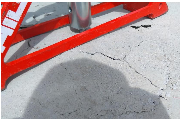
Obrázek 66 Porušení betonu při vytahování přetažené expanzní kotvy HST3 M10x100
