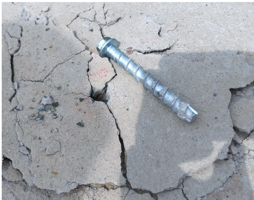
Obrázek 52 Upevňovací šroub HUS3-H s rozpadlým betonovým kuželem
