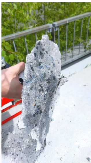
Obrázek 47 Vytržený betonový kužel
