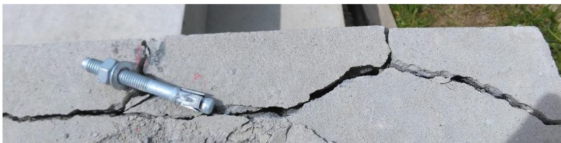
Obrázek 54 Expanzní kotva HST3 s poškozeným podkladním materiálem
