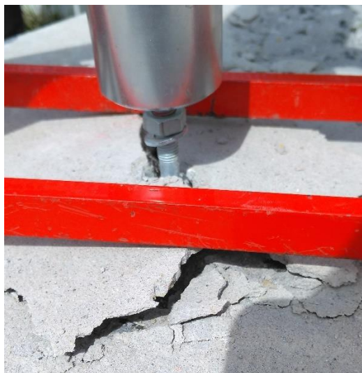
Obrázek 62 Poškození podkladního materiálu vlivem vytažení expanzní kotvy HST3 M10x100
