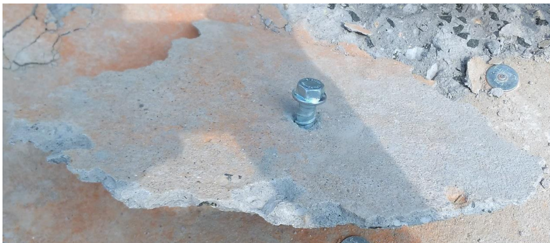
Obrázek 64 Vytržený betonový kužel při nedodržení min. osových vzdáleností a nevyčištění kotevního otvoru
