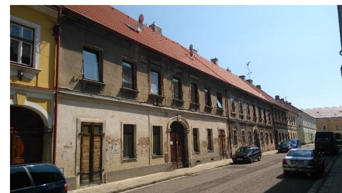
Obr. 23 Původní fasáda- Nevhodně zvolená výplň okenních otvorů
