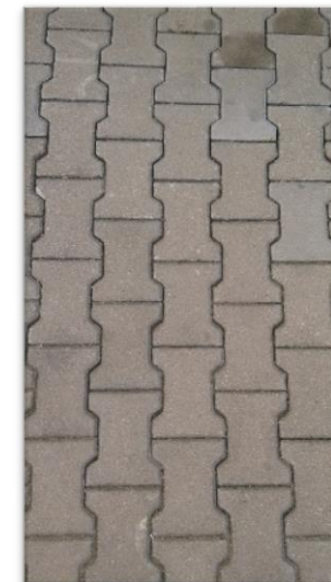
Obr. 37 Nevhodně zvolená úprava povrchu v podobě betonové zámkové dlažby
