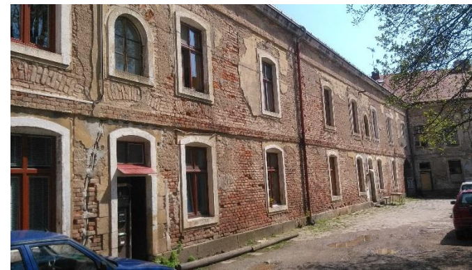
Obr. 26 Okružních kasárny ve východní části čekající na obnovu.
