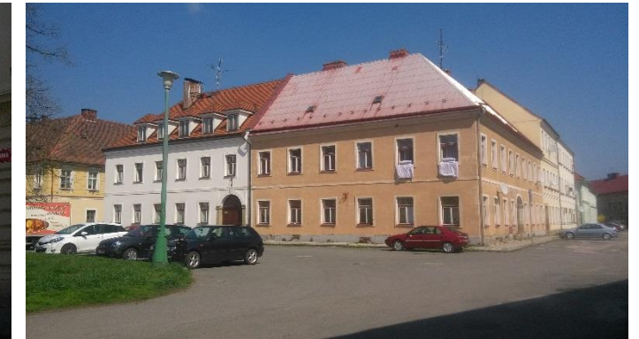
Obr. 24 Nově opravená fasáda civilního domu- Nevhodná pokrývka střechy s plechových šablon
