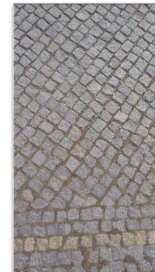
Obr. 39 Vhodně zvolená žulová dlažba menších rozměrů
