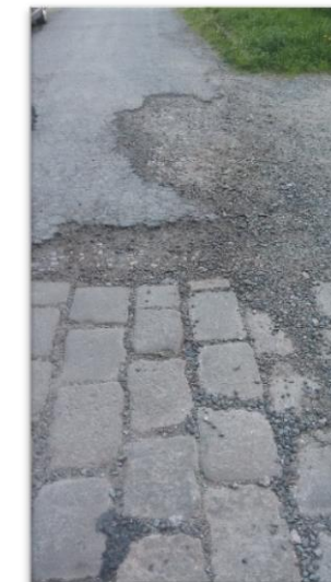
Obr. 38 Neudržovaný povrch místní komunikace
