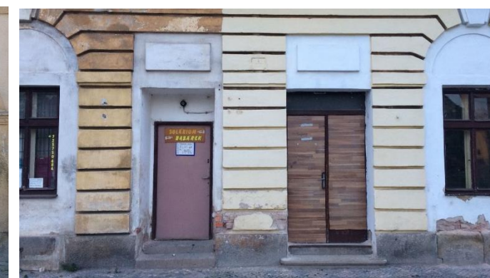
Obr. 35 Nevhodně zvolené vyplně vchodových dveří u objektu s občanskou vybaveností
