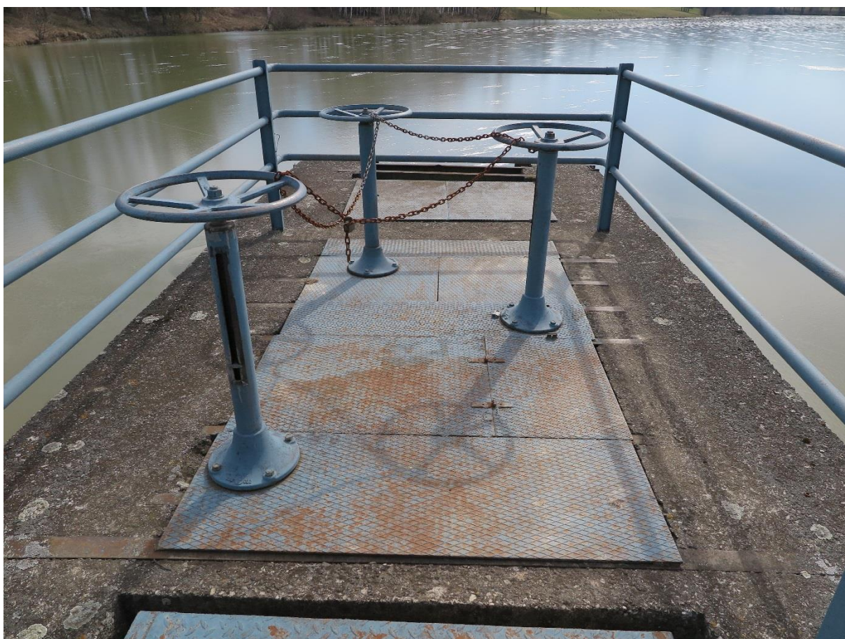
Obrázek 4.4.4: Pohled na ovládání uzávěru spodních výpustí
