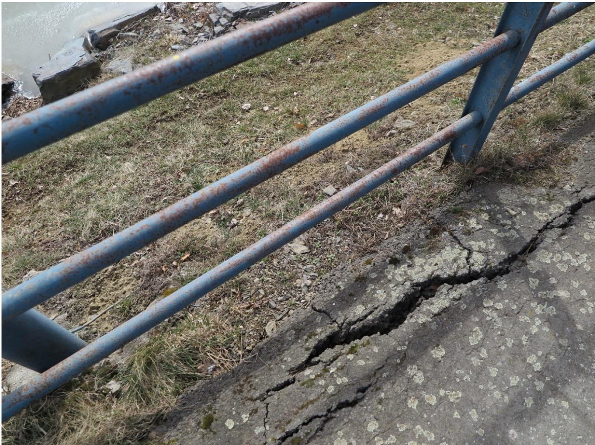
Obrázek 4.3.1: Příklad potrhane asfaltu na koruně hráze
