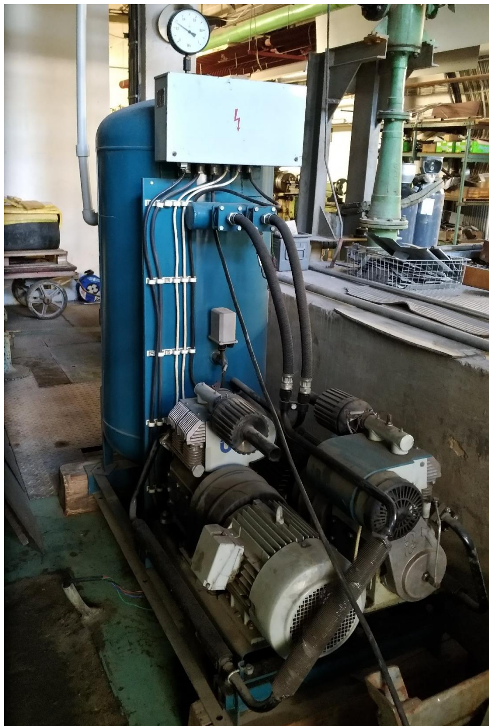
Obrázek 46 - Kompresorová stanice - zdroj stlačeného vzduchu
