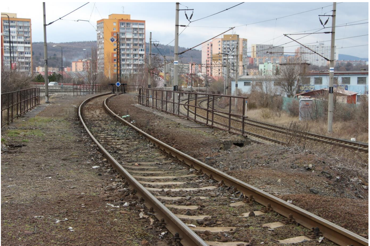
Obrázek č. 2 – km 64,000, směr Most, kolej č. 4c
