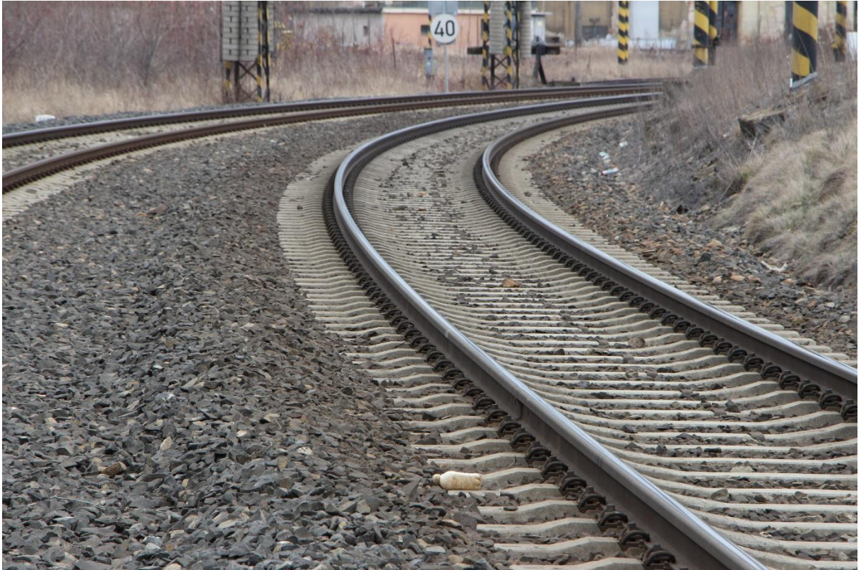
Obrázek č. 1 – km 64,000, směr Kadaň, kolej č. 2
