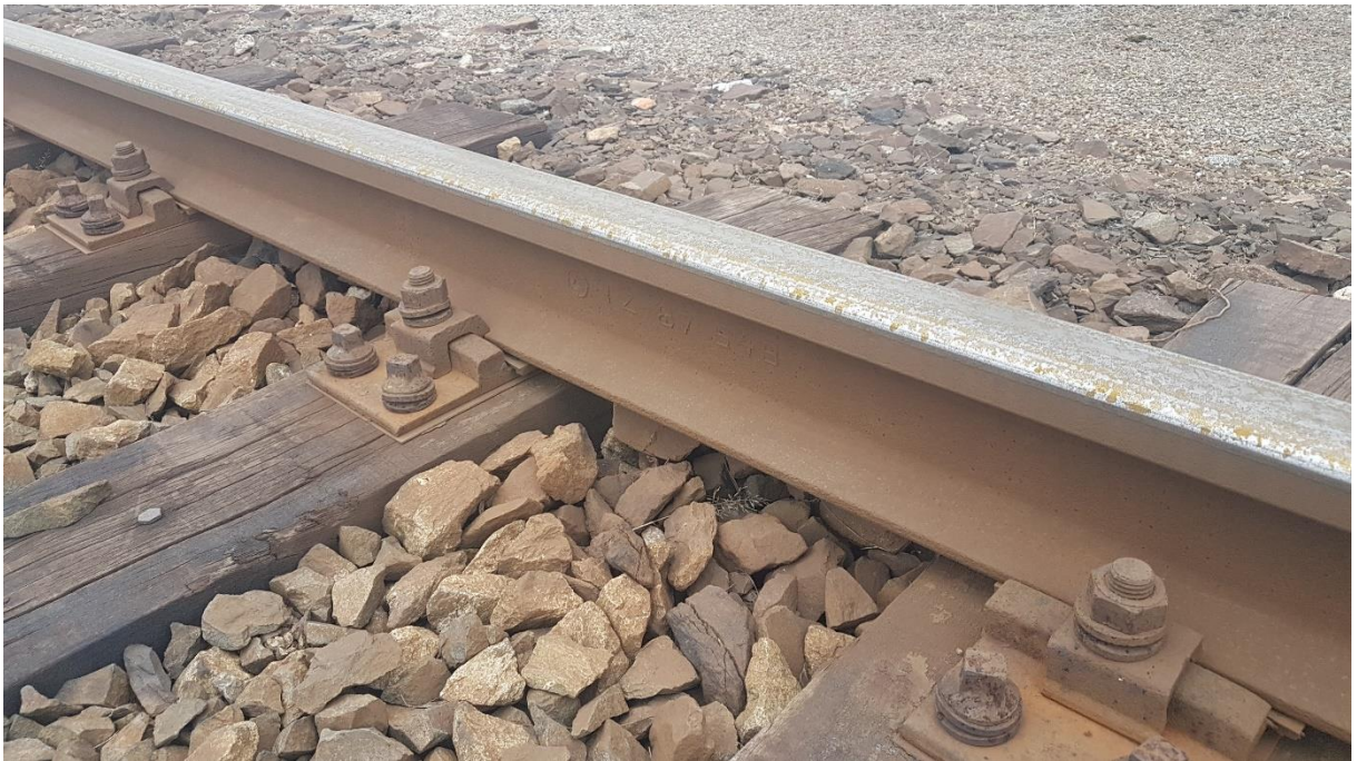
Obrázek č. 8 – km 64,400, kolejnice S49 – detail
