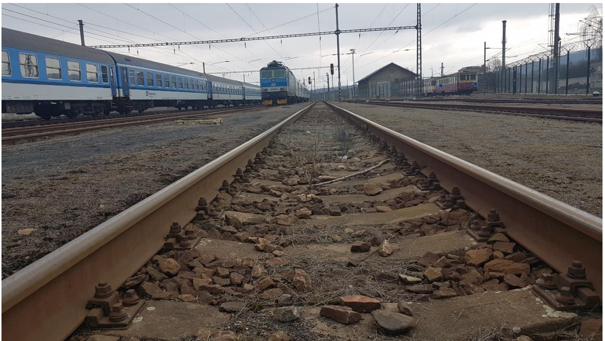
Obrázek č. 26 – km 64,850, směr Kadaň, kolej č. 10 – detail
