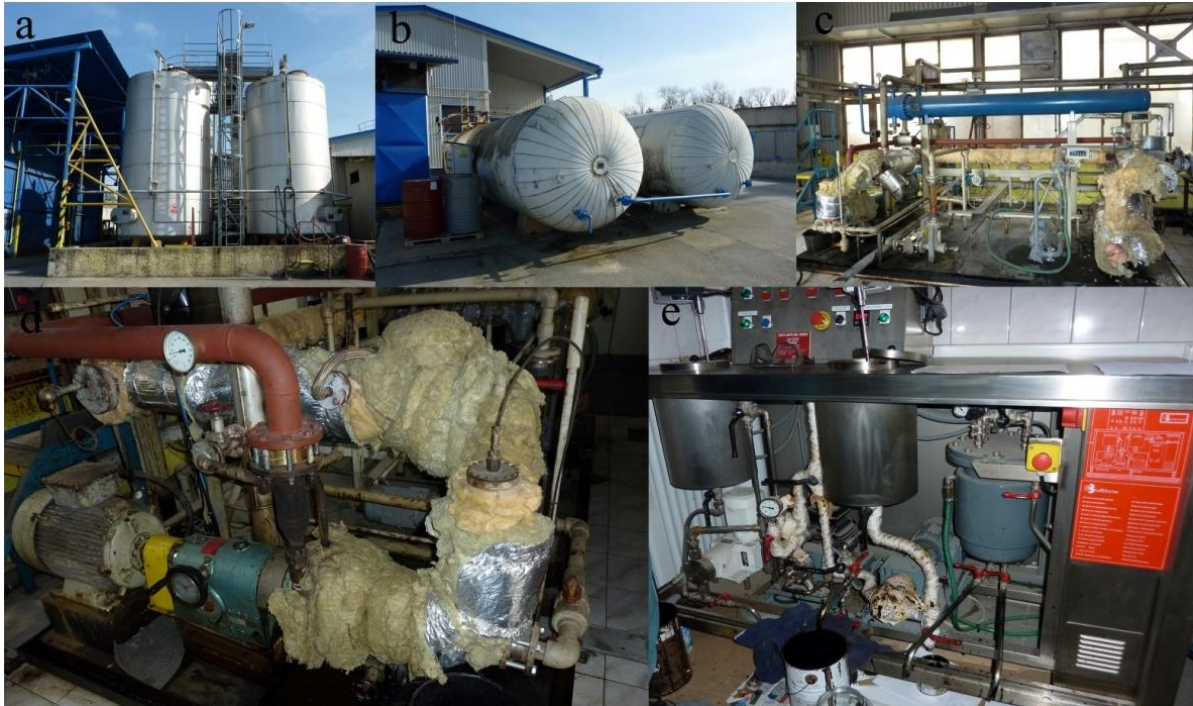
Obrázek 19: Emulgační stanice Eurovia-Kolín - a) zásobník asfaltového pojiva, b) zásobníky s vodou, c) emulgační zařízení, d) koloidní mlýn, e) Laboratoř Eurovia - laboratorní emulgační zařízení 11
