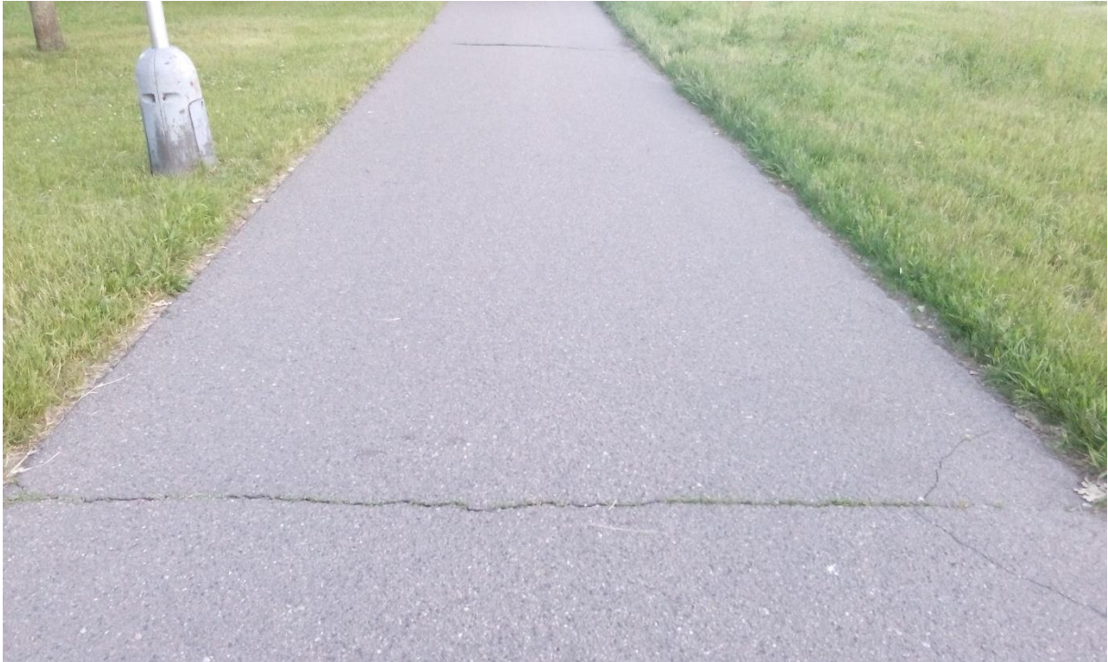
Obrázek 3. Opakující se nízkoteplotní trhliny na cyklostezce v Pardubicích (foto autor).
