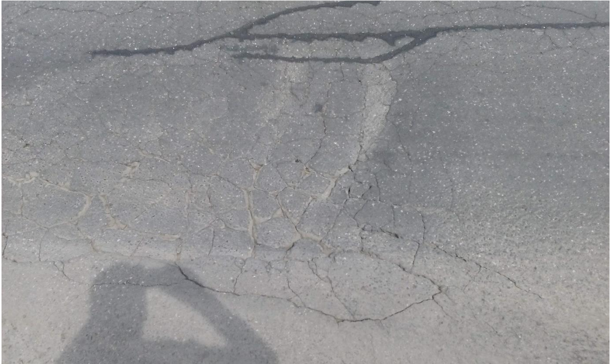
Obrázek 2. Únavové trhliny na komunikaci I/12 v Újezdě nad Lesy (foto autor).
