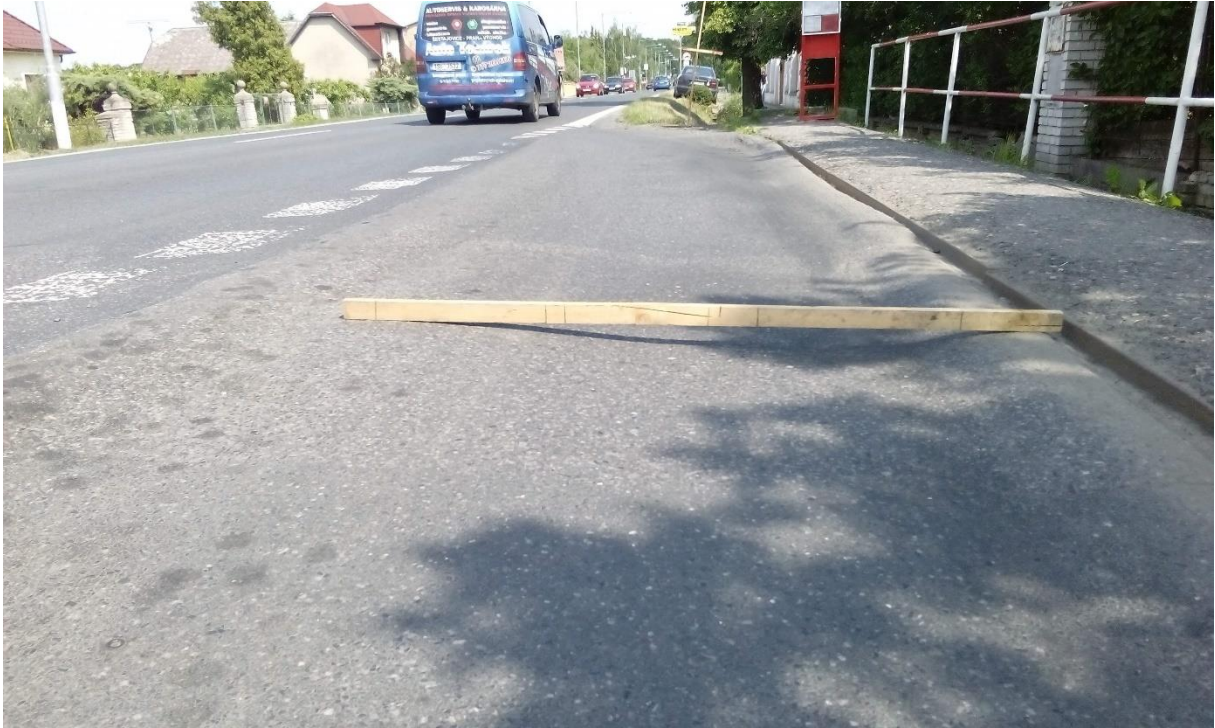
Obrázek 1. Vyjeté koleje na autobusové zastávce v Újezdě nad Lesy (foto autor).
