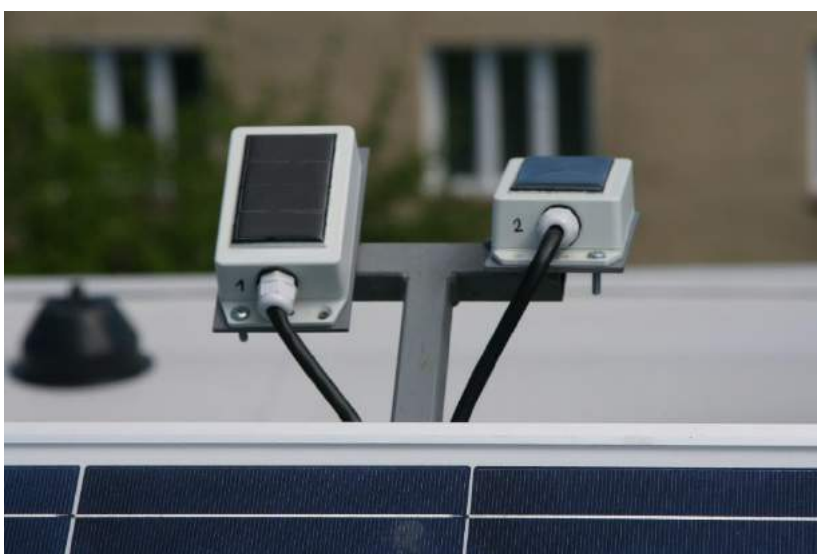
Obrázek 5.2 - Čidla osvitů instalovaná u FV panelů na budově FÉNIX (číslo 1 ve sklonu s panely, č. 2 je čidlo horizontální) [24]
