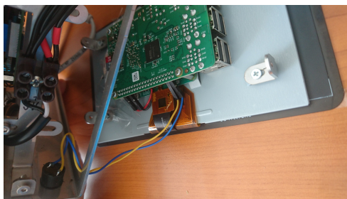
Obr. 2.5: Pripojenie zvukovej signalizácie
