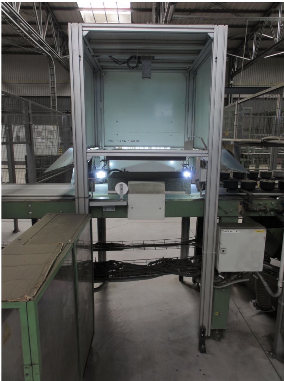
Obrázek 3.2: Instalovaný kamerový box.
