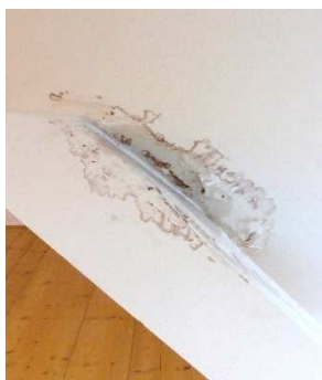
Obr. 18: Problém se zatékáním v podkroví domu v Říčanech (foto Eva Bortelová)
