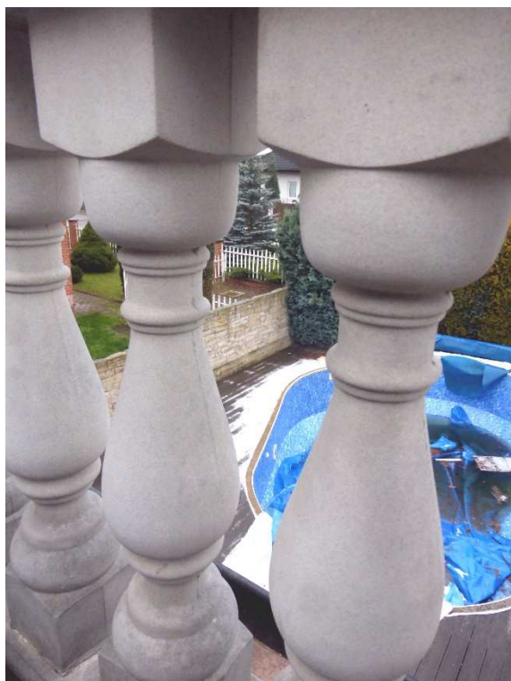
Obr. 23: Dům v Uhříněvsi - detail betonové balustrády (foto Eva Bortelová)
