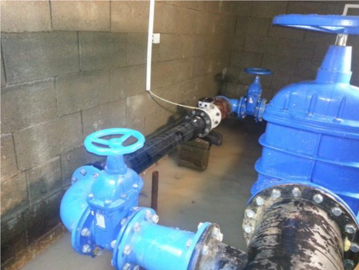
Obr. 12 Umístění kuponů na VDJ Hodušín
