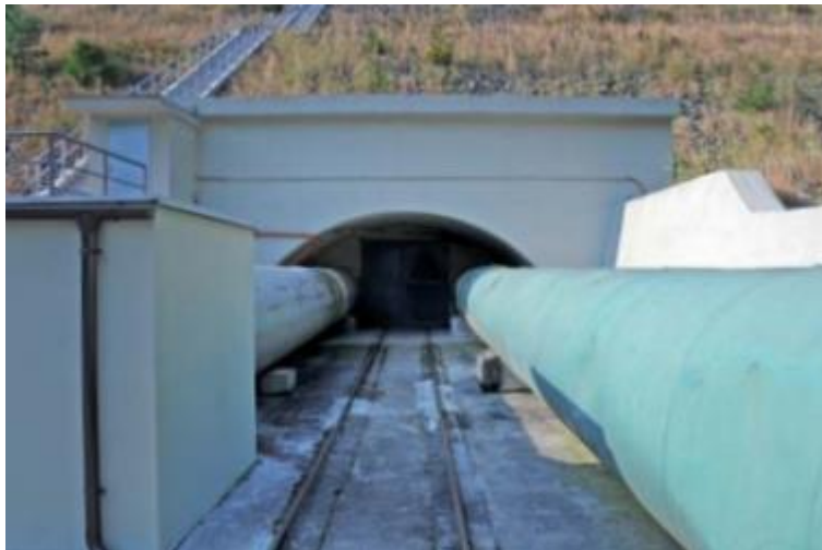
Obr. 4 Potrubí o průměru 1200 milimetrů přivádí surovou vodu. Zdroj: www.jvs.cz
