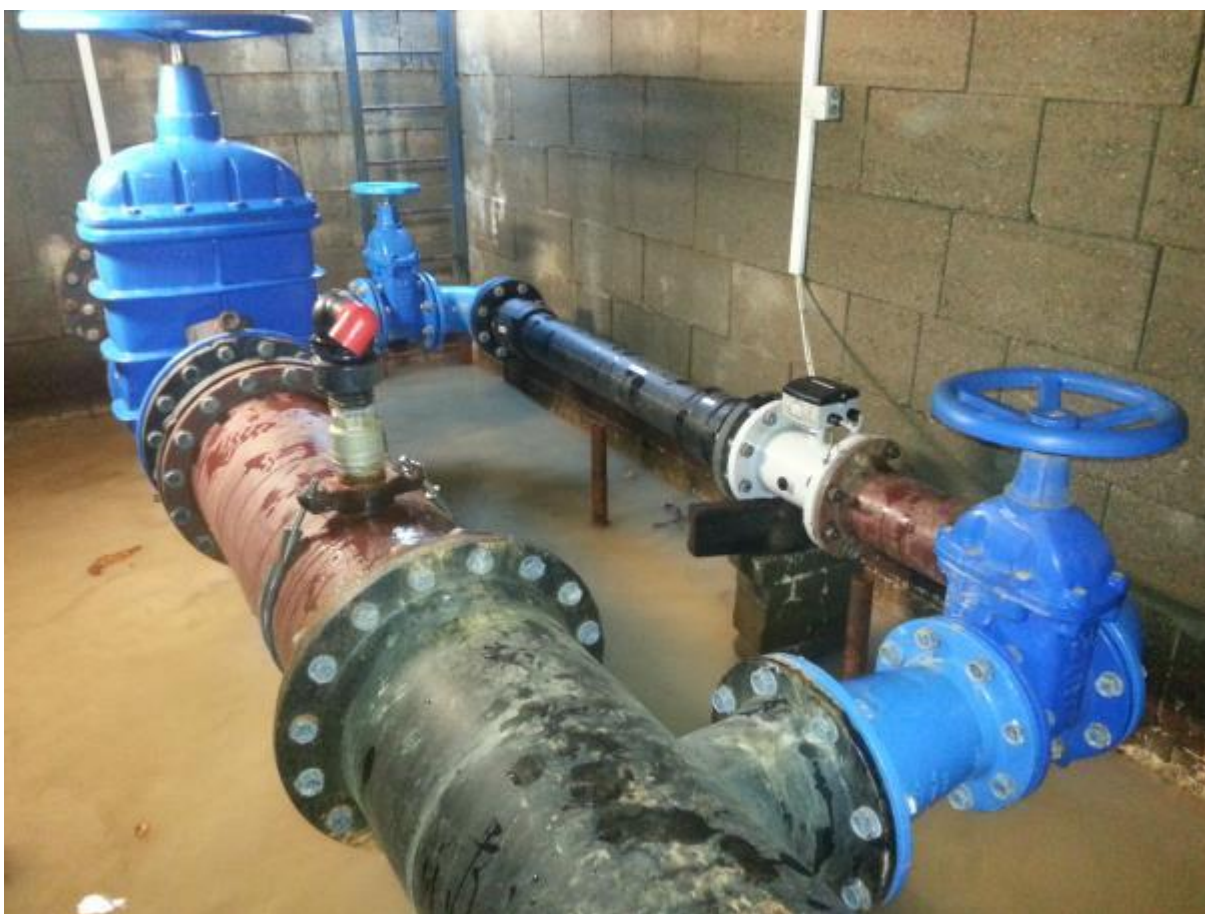
Obr. 19 Obtok na odtoku z VDJ Hodušín II směrem do VDJ Milevsko - nový
