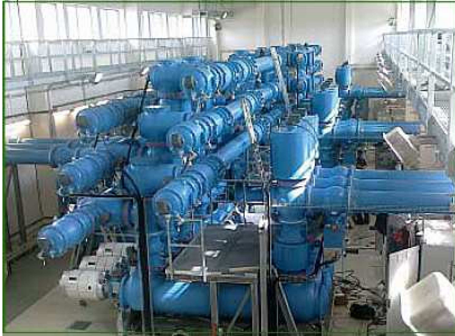
Obrázek 10 Zapouzdřená rozvodna Chotějovice 16
