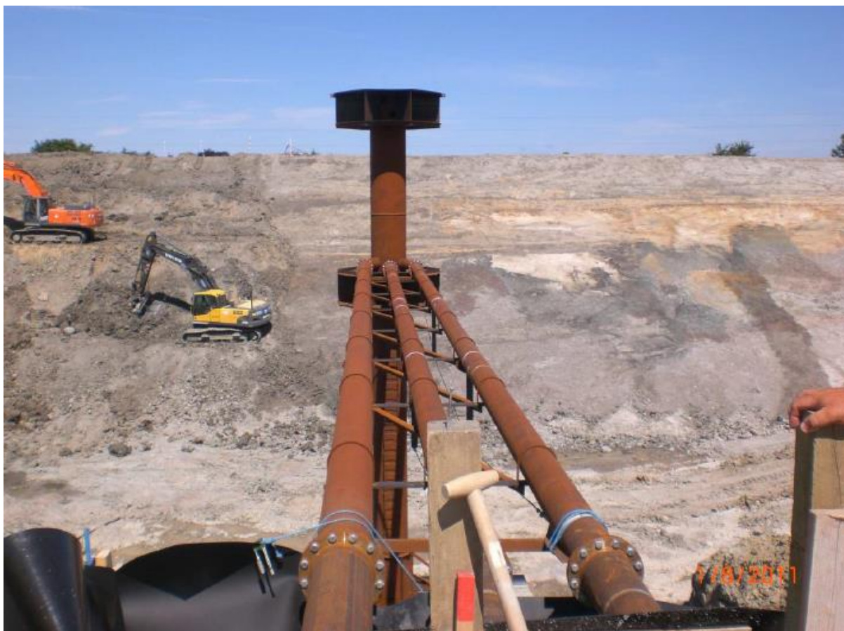
Obrázek 10: Potrubí vstupující skrz stěny do nádrže. SUNSTORE 4, Marstal [4]
