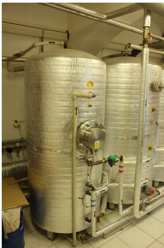
Obrázek 28: Vlevo zásobník TV vybaven elektrickou topnou vložkou. Vpravo pohotovostní zásobník pro otopnou soustavu. [archiv O. Mareš]
