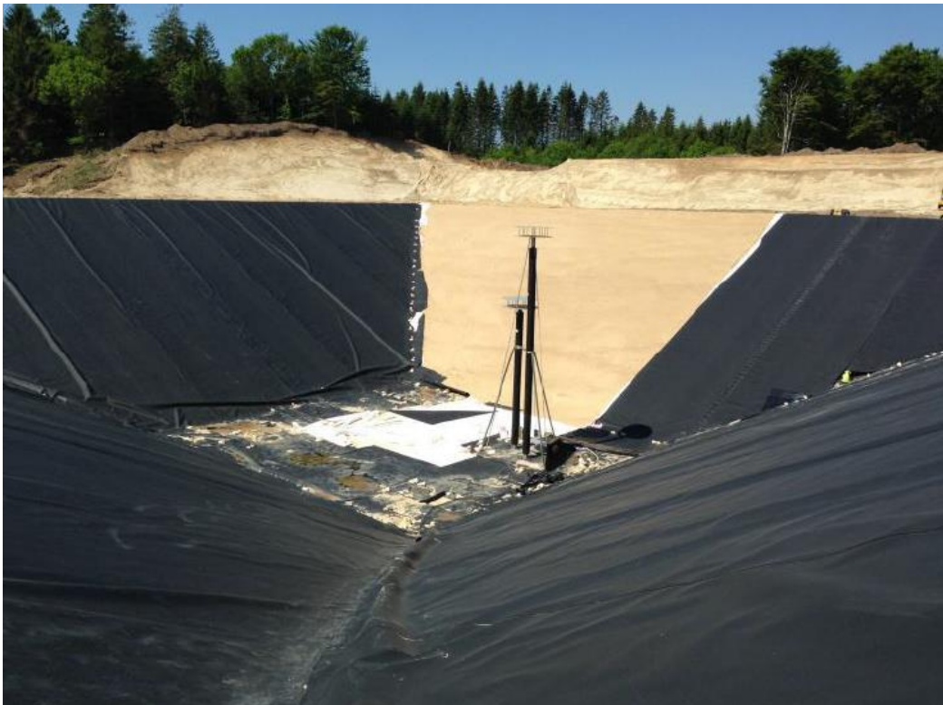
Obrázek 9: Potrubí vstupující skrz dno do nádrže. SUNSTORE 3, Dronninglund [4]
