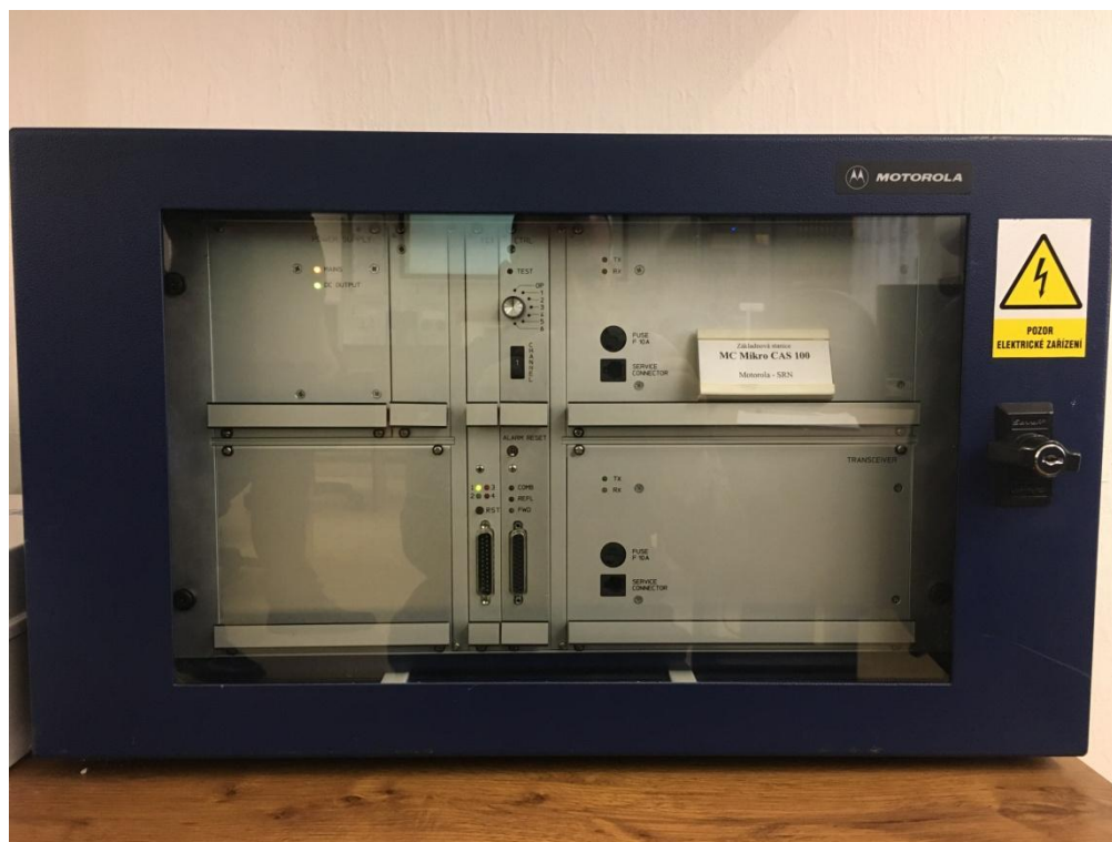
Obr. 41 – Vysílací stanice JSVV. [100 LB]
