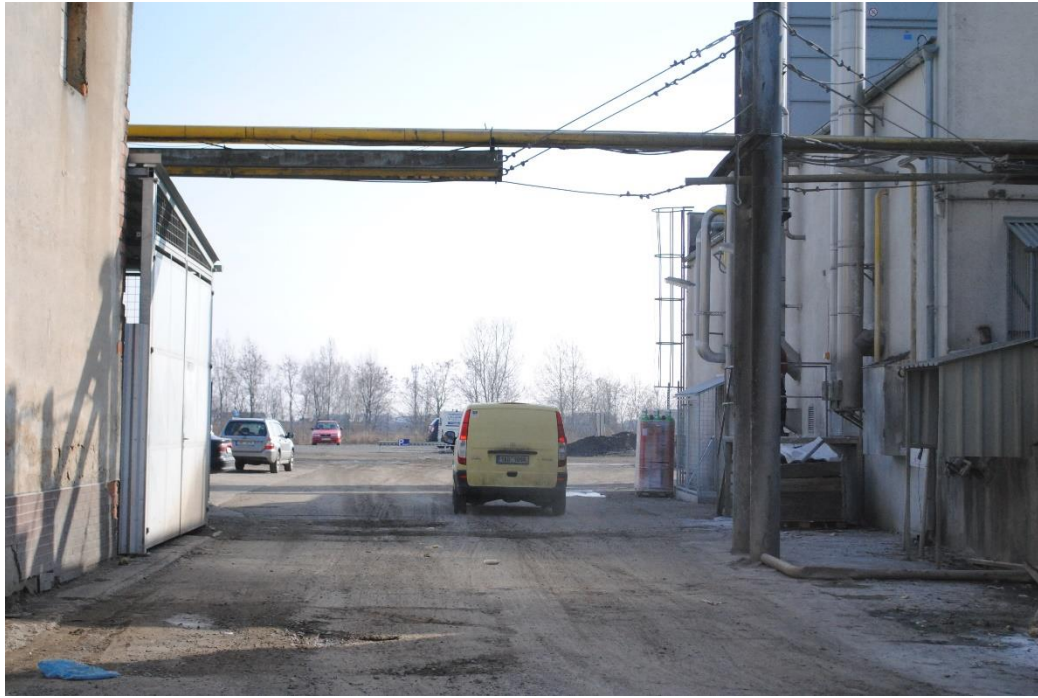
Obrázek 6 - Plynovod v blízkosti strojovny S1. Dodávka na snímku není pod vedením plynu (zdroj: autor)
