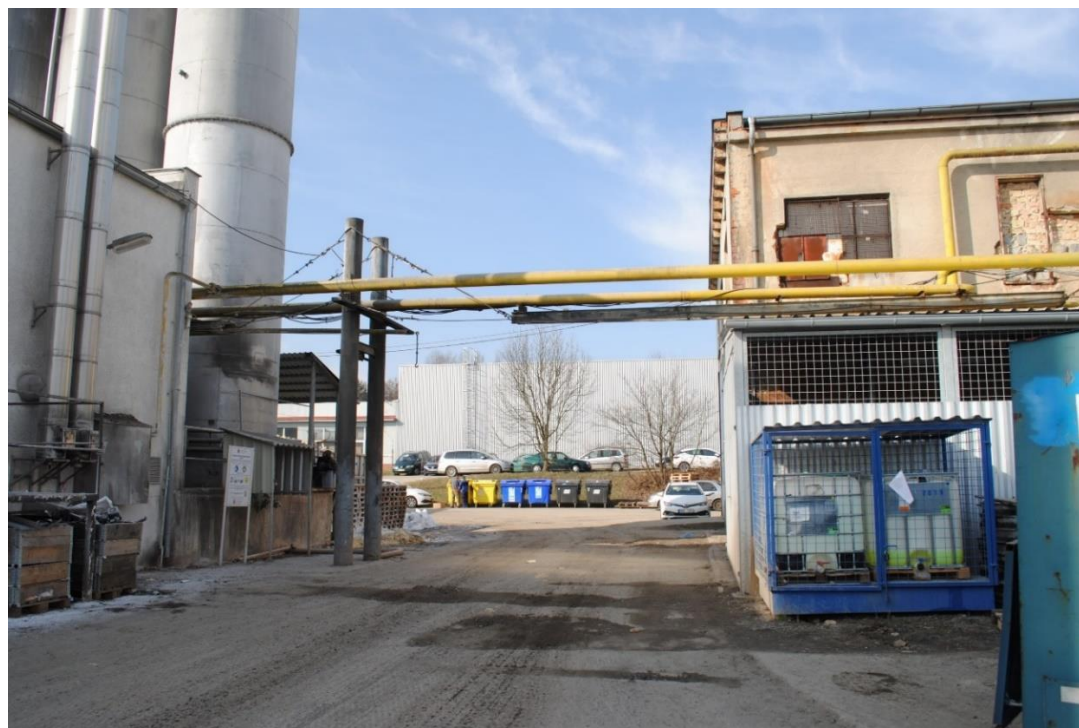
Obrázek 13 – Plynovod z druhé strany. Po levé straně se nachází sila VMP 1,2,3 i s plnicím terminálem, úplně vlevo se nachází kotelna K3. Na pravé straně, mimo záběr, se nachází regulační stanice plynu, která pomocí plynovodu uprostřed zásobuje kotelnu podniku plynem (zdroj: autor)
