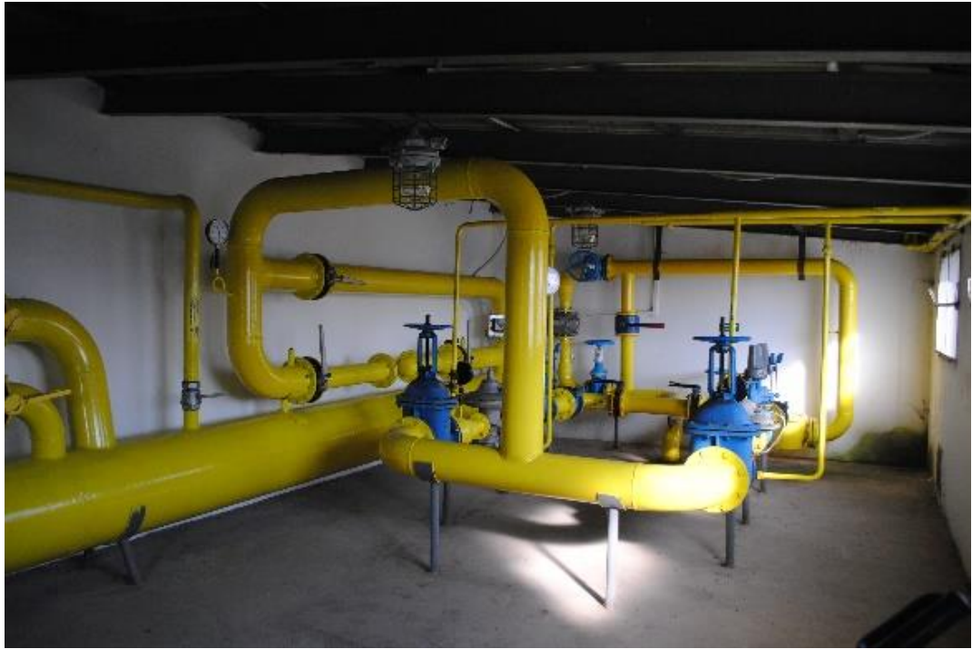
Regulační stanice plynu (zdroj: autor)
