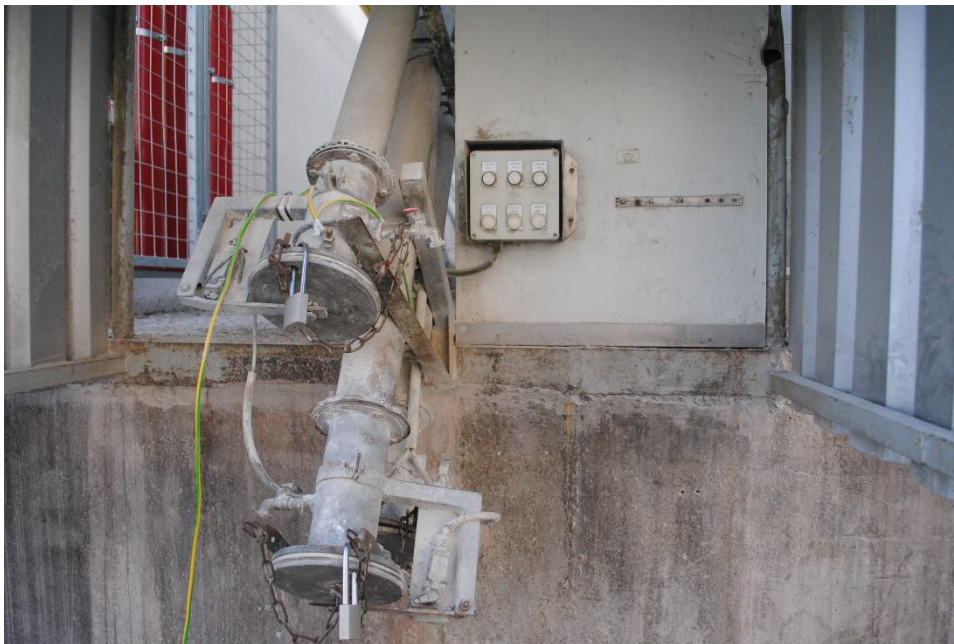
Obrázek 12 Terminál pro připojení plnicích hadic cisterny s kontrolními tlačítky (zdroj: autor)
