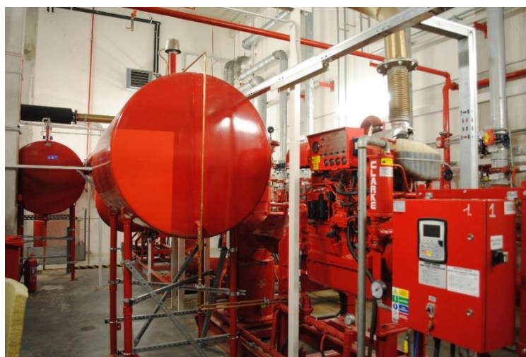
Obrázek 10 - Strojovna systému sprinklerů (zdroj: autor)
