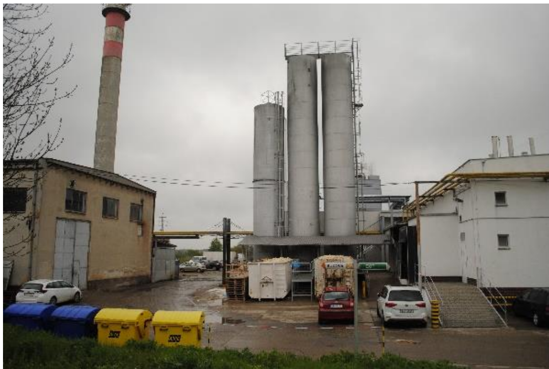
Pohled na plynovod a sila pro linky L1 až L4 (zdroj: autor)
