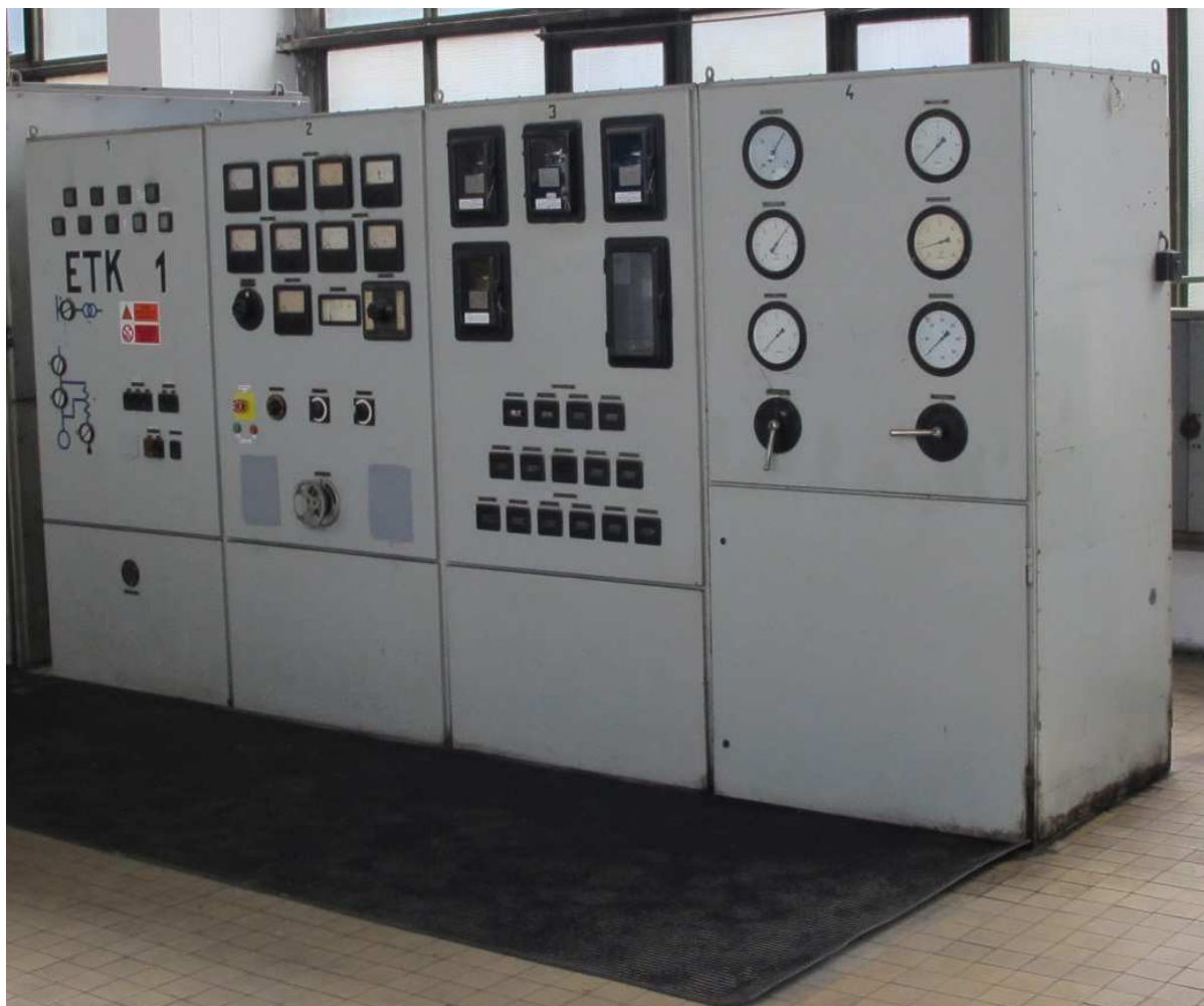
Obrázek 4 - Pohled na ovládací rozváděče turbokompresoru 16 000 m 3 /hod, důl ČSM Jih
