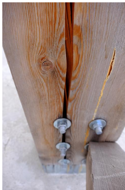
Obrázek 4: Výsušné trhliny v místě spojovacích prostředků
