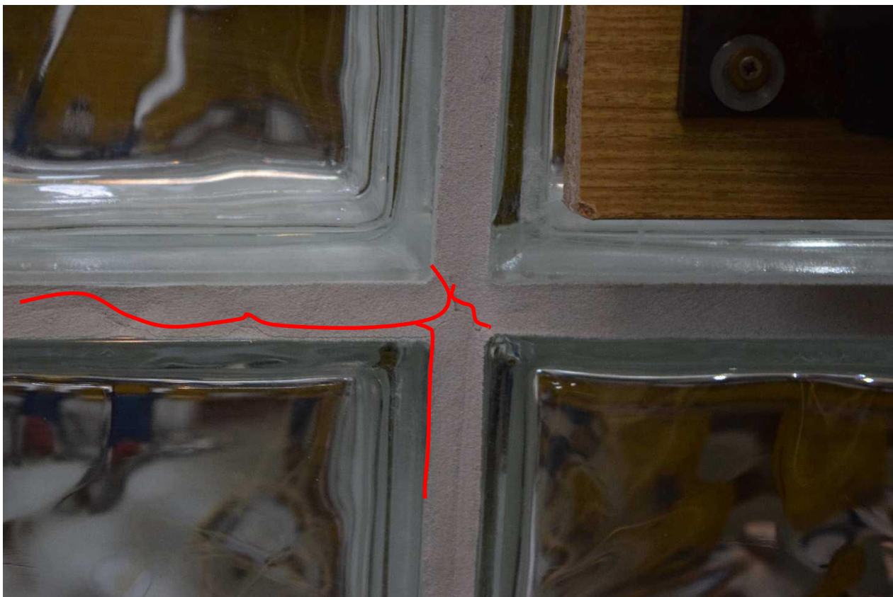
Obr. 81 Trhliny na tlačené straně
