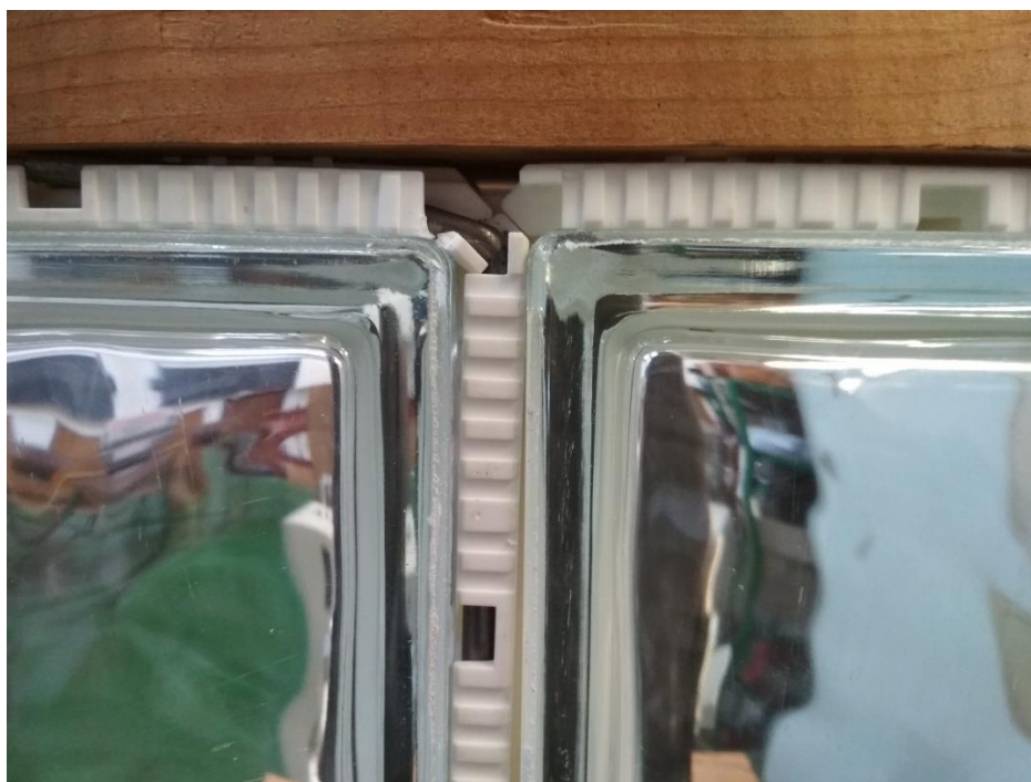
Obr. 64 Zdeformovaný roh rámečku
