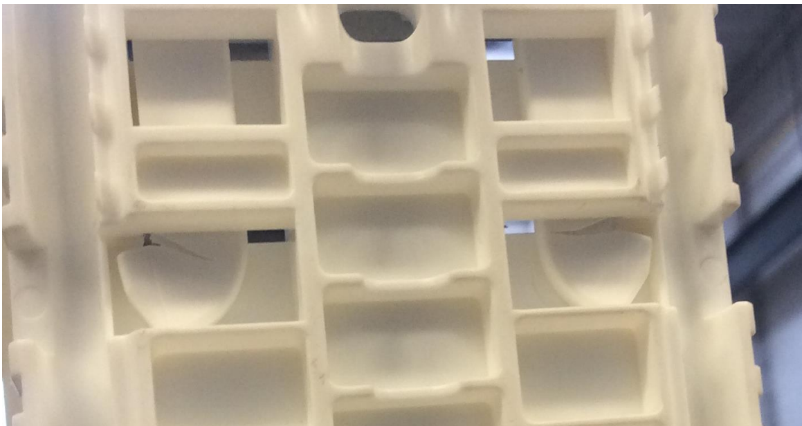
Obr. 50 Porušení paciček prostorového kříže
