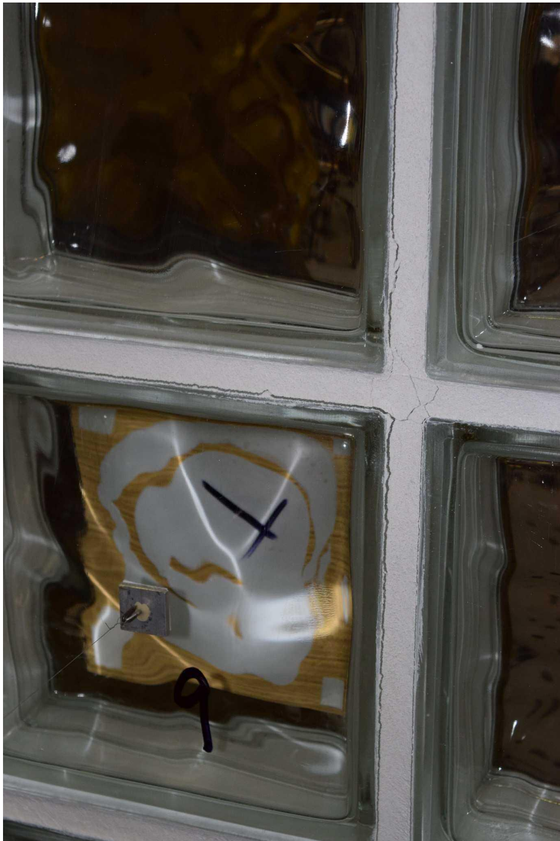
Obr. 80 Rozvoj trhlin na tažené straně
