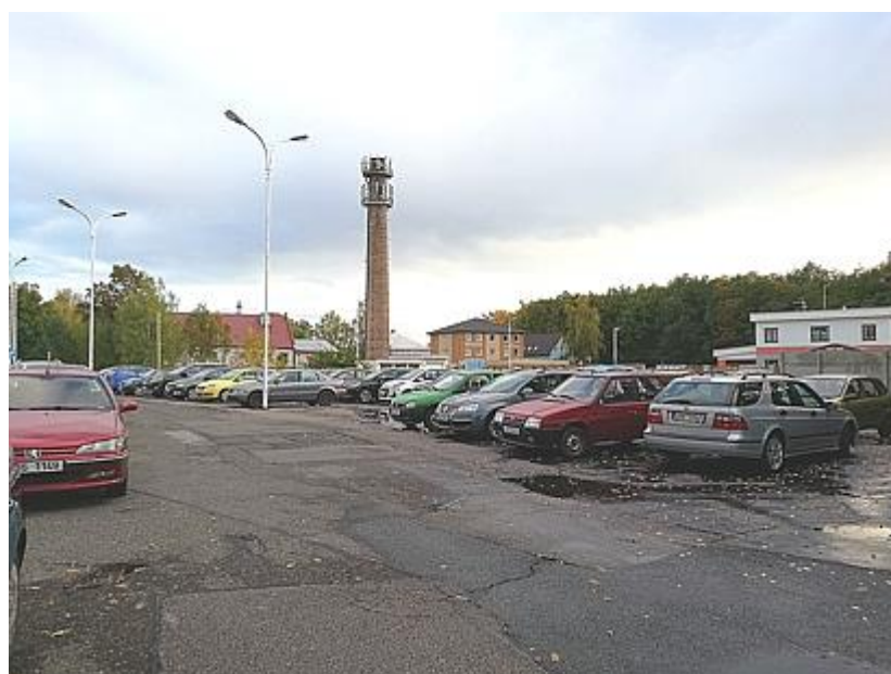
Foto 56 Jižní pohled na plochu pro parkování. Jedná se o střední parkoviště bez vyznačení jednotlivých parkovacích stání. Asfaltový povrch komunikace je ve velmi špatném stavu.
