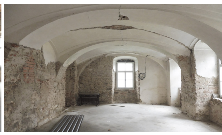
Část omítek byla otlučena (E.1.1.).
