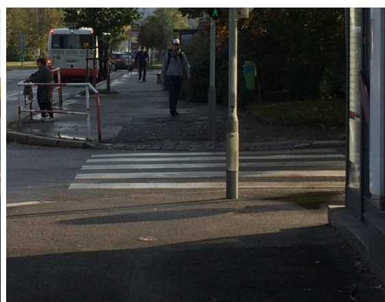
Obr. D41 – Přečhod pro chodce, jižní rameno; snížený obrubník není na celou šířku přečhodu, hmatové úpravy nezřízeny
