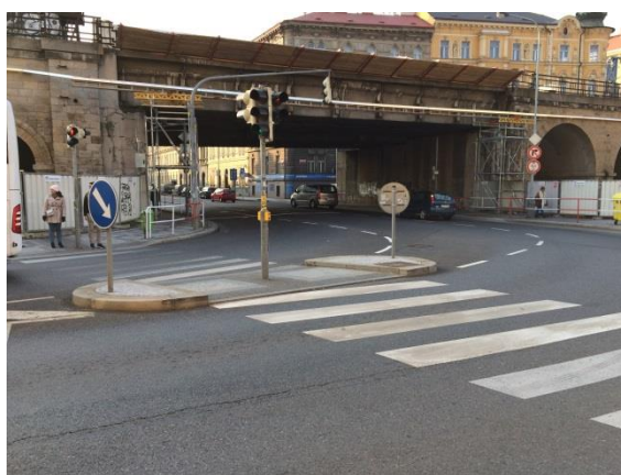
Obr. D82 – Detail přechodu s nevyhovujícím rozhledem a probíhající stavební úpravy mostu
