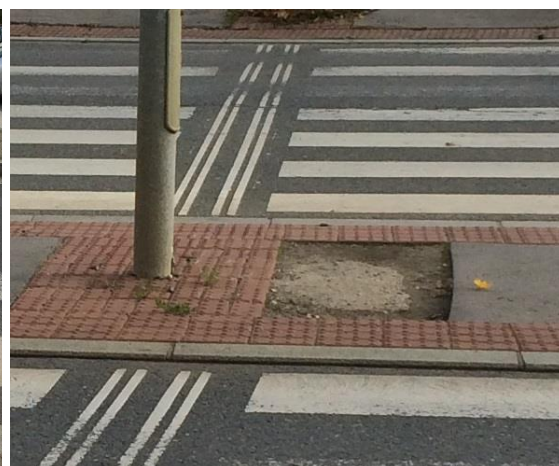
Obr. D53 – Přečhod pro chodce, jižní rameno; poškozený chodník na dělicím ostrůvku
