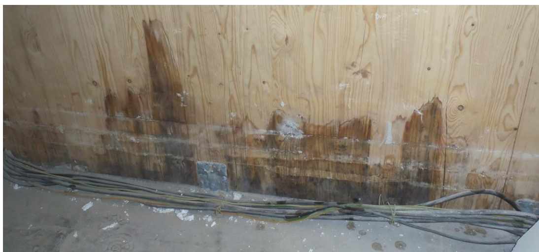
Obr.22: Vlhkostní mapa zasažené dřevěné konstrukce
