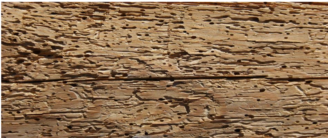
Obr. 11: Detail dřevěné konstrukce poškozené červotočem umrlčím
