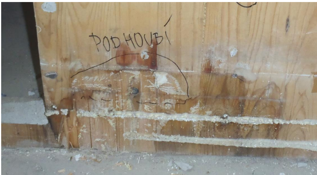
Obr.23: Vlhkostní mapa zasažené dřevěné konstrukce spolu s rozvíjejícím se podhoubím
