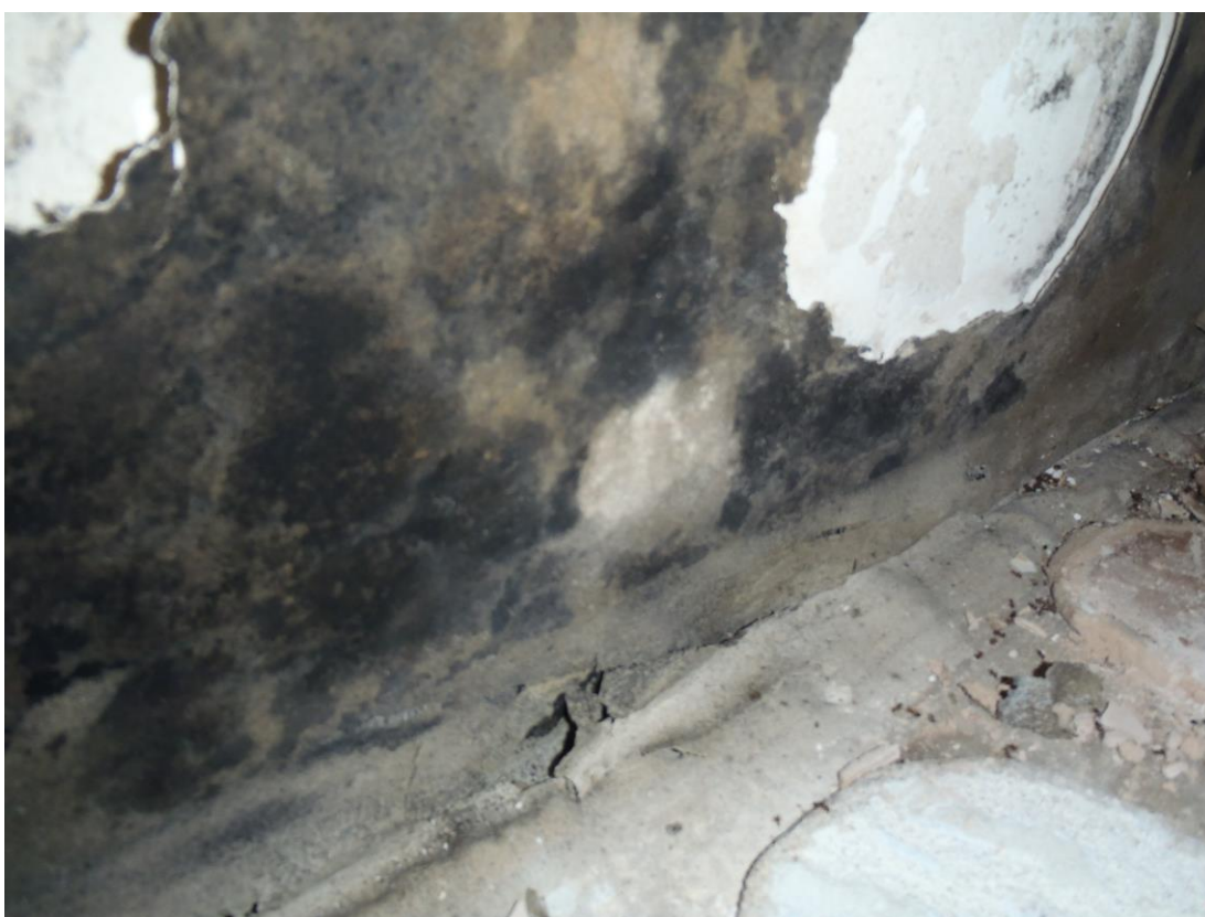
Obr.24: Zdegradovaná nátěrová hydroizolace s položením dlažby na tzv. „buchtý“
