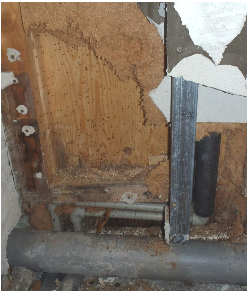
Obr.25: Znehodnocení dřevěné stěny vlivem vlhkosti, dřevokazné houby a hmyzu
