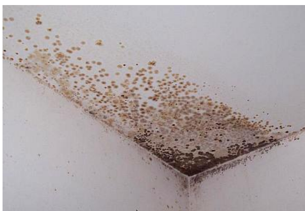
Obr.8: Plíseň v interiéru
