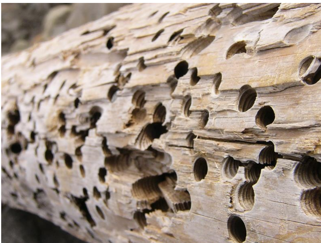
Obr.9: Degradovaný prvek dřevokazným hmyzem
